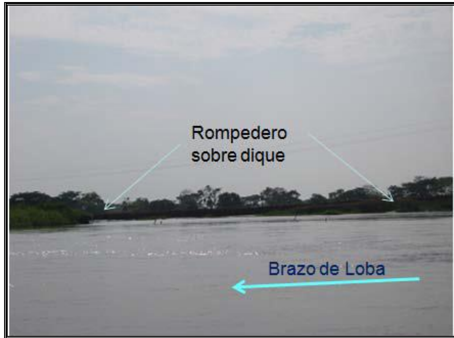
Figura 1: Rompedero sobre dique existente Tramo de dique que se perdió por el rompedero, se alcanza a visualizar algo del dique se construyó en la parte posterior
