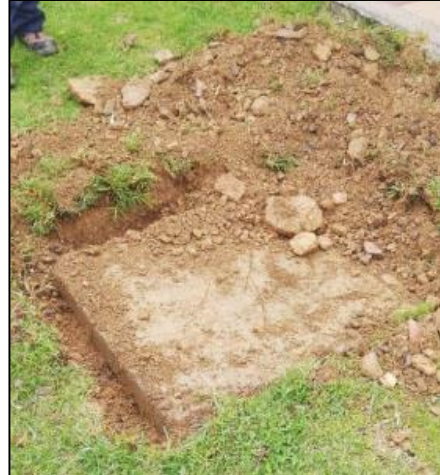
Ilustración 13. Estado cajas del restaurante.
