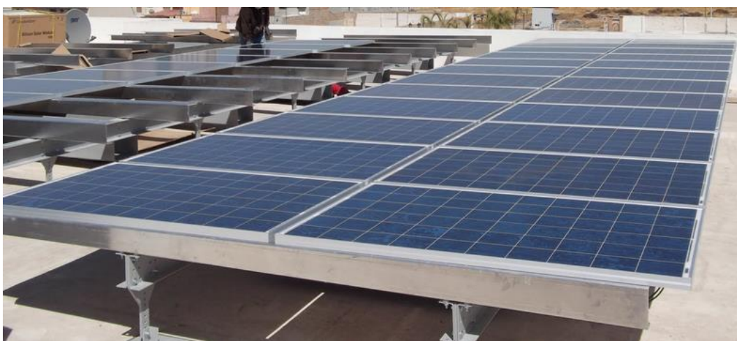
Ilustración 20. Estructura para la instalación de los paneles Solares Fotovoltaica. Imagen tomada de: http://eliseosebastian.com/wp-content/uploads/2012/11/ESTRUCTURA-PV-300x154.jpg
