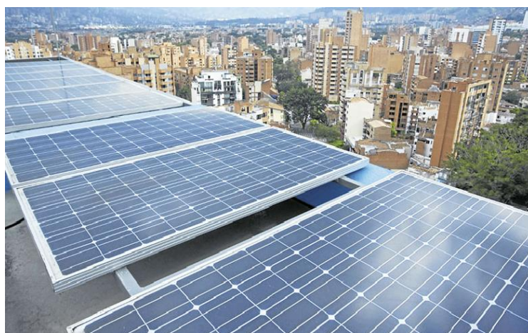
Ilustración 14. Paneles solares instalados en edificios de Pereira. Imagen tomada de [19].
