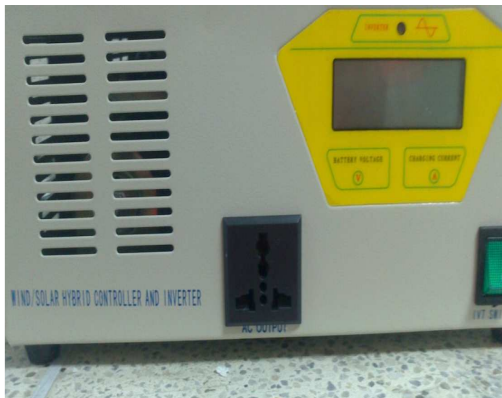
Imagen tomada en la universidad Militar Nueva granada caja inversora y reguladora.
