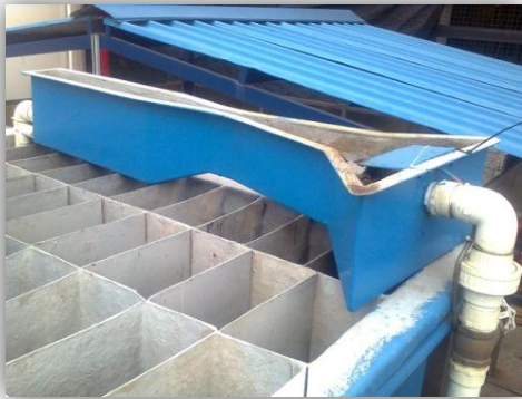
Figura No 2. Canaleta Parshall PTAP municipio de El Peñol – Antioquia.
