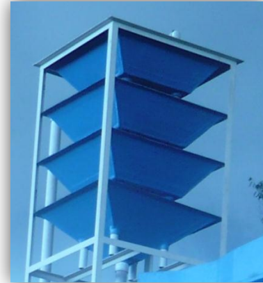
Figura No 1. Torre de aeración PTAP municipio de Chiquinquirá, vereda Hato de Susa.
