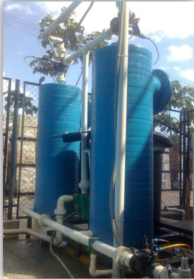
Figura No 5. Filtros a presión PTAP del almacén Homecenter Villavicencio – Meta.
