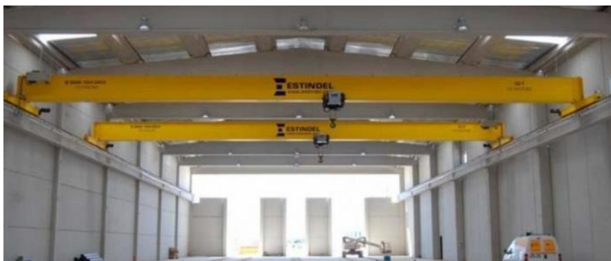
Imagen 2. Dos PGR instalados en bodega de lamacenamiento.
