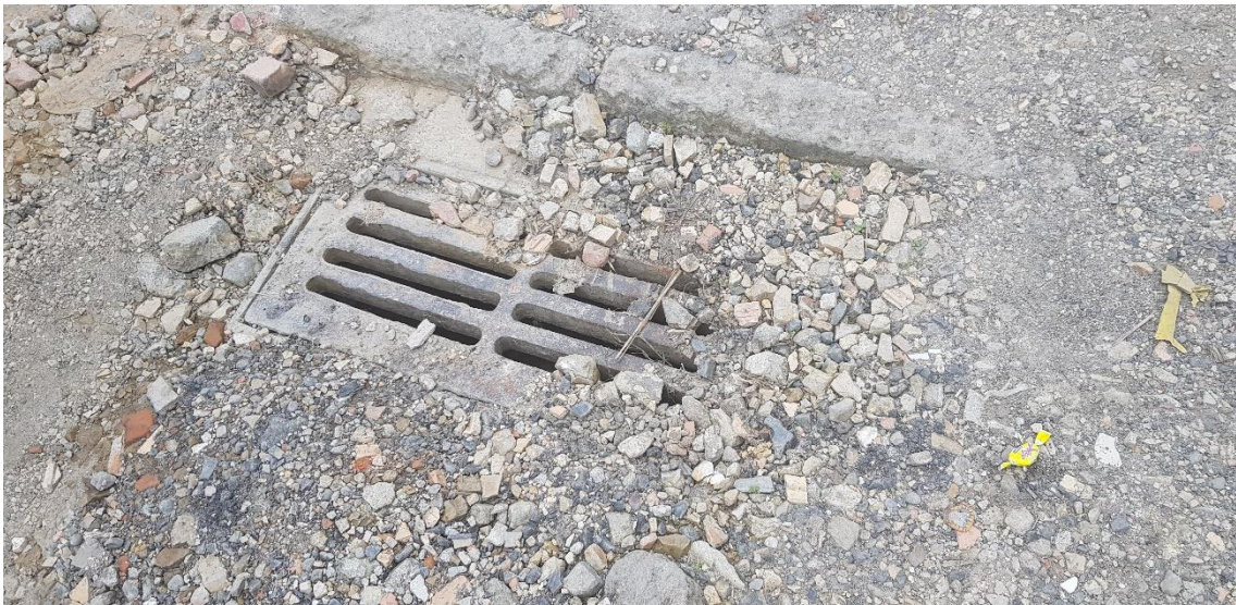
Figura 8. ARRASTRE DE MATERIALES HACIA LAS OBRAS DE DRENAJE Fuente: Propia.
