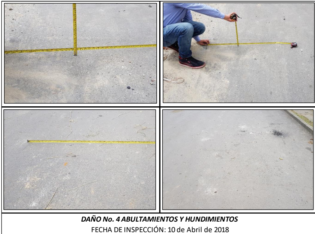
Figura 4. DAÑO TIPO HUNDIMIENTO Fuente: Propia.
