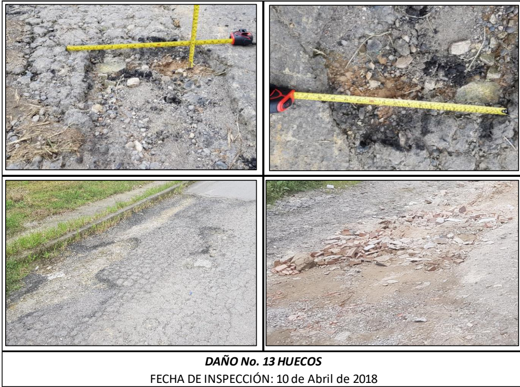
Figura 6. DAÑO TIPO HUECO Fuente: Propia.
