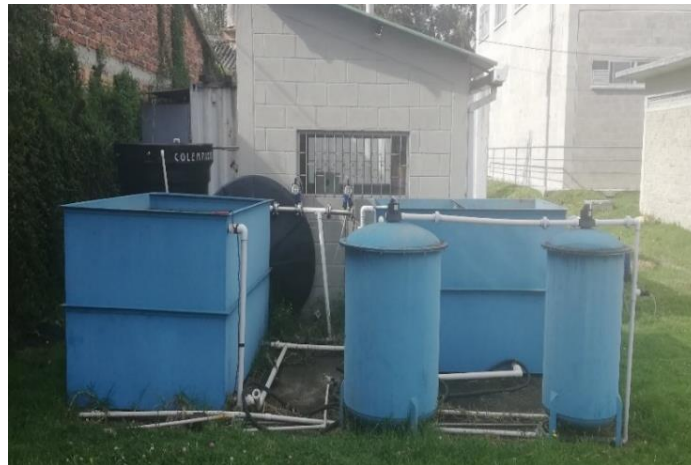
Ilustración 3 Tanques de almacenamiento de agua
