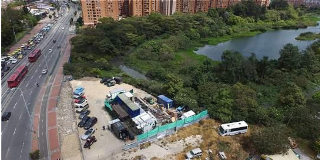
Figura 2 Obra ilegal y vertimiento de aguas negras que afectan al Humedal Córdoba/ Bogotá. Fuente: El Tiempo.com (2016).
