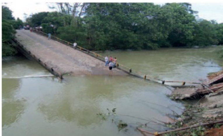
Figura 13. Puente Riecito colapsado
