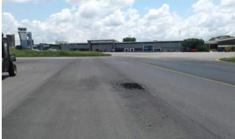
Ilustración 7. Bache en calle de rodaje Bravo (Aeropuerto neiva)
