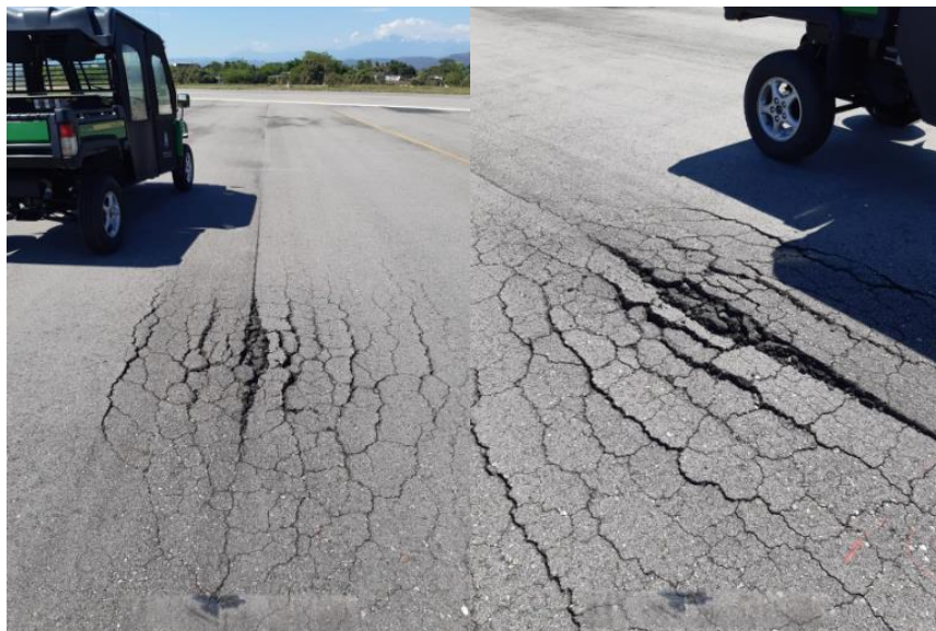
Ilustración 8 y 9. Bache en calle de rodaje Bravo (Aeropuerto de Neiva)
