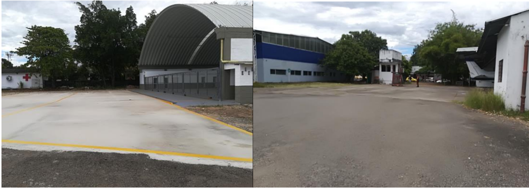
Ilustración 12 y 13. Estado entrada hangares (Aeropuerto de Neiva)
