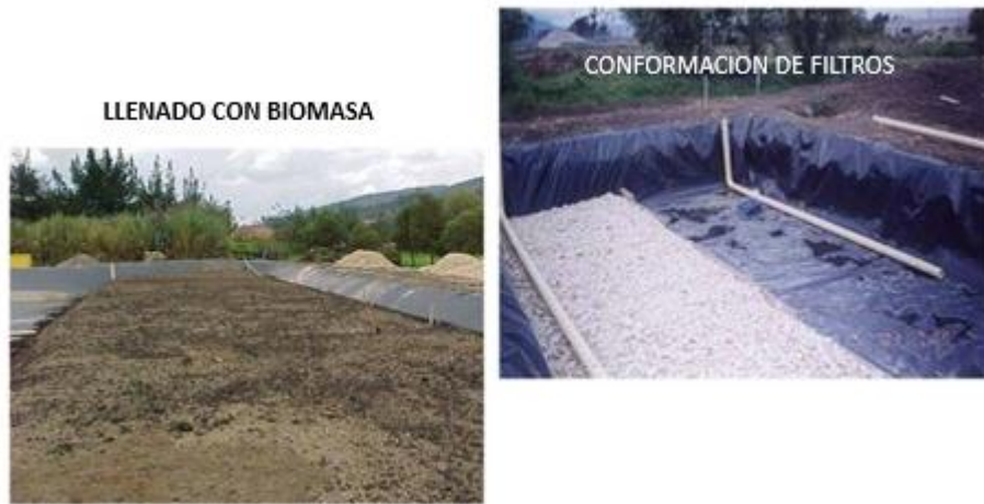
Figura 6 Llenado y filtros de la piscina; Fuente(BIOLODOS & León, 2020)
