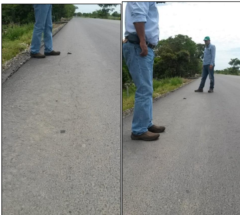
Imagen 8. Ubicación de la fisura. a) Ubicación de la fisura desde el borde de la carpeta asfáltica. b) estimación de longitud de la fisura
