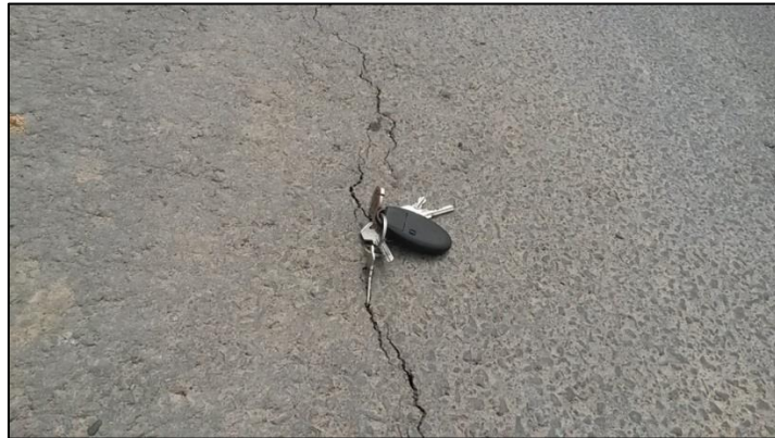
Imagen 9. Ancho promedio de la fisura.
