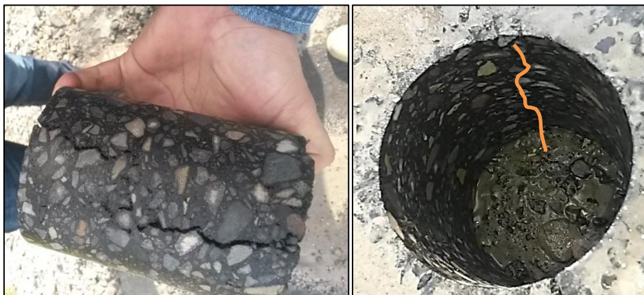
Imagen 14. Núcleo 1 Abscisa K1+340. a) núcleo extraído en el sitio donde tiene un mayor ancho. b) Orificio del núcleo extraído en la carpeta asfáltica.
