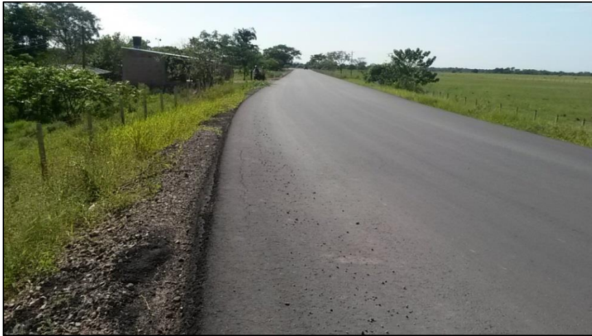
Imagen 11. Ubicación de la fisura desde el borde de la carpeta asfáltica.
