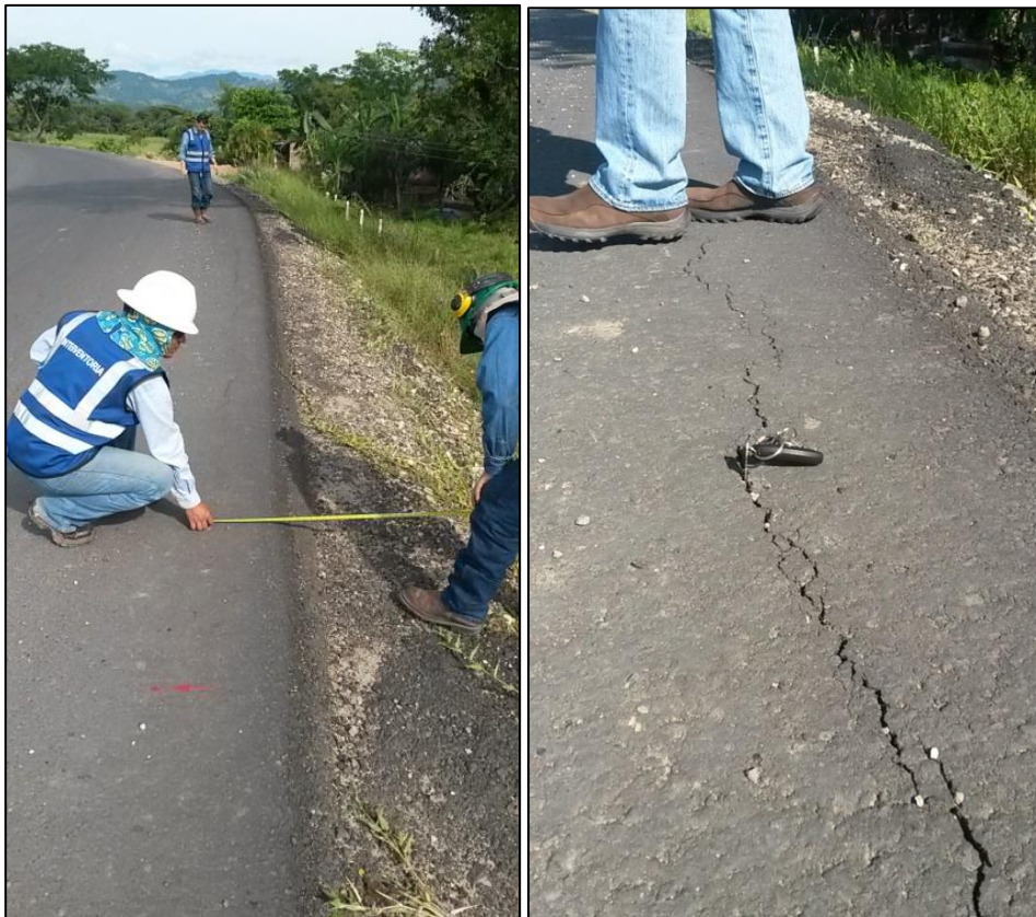
Imagen 12. Longitud y ancho de la fisura. a) Ubicación de la fisura desde el borde de la carpeta asfáltica, se observa la longitud aproximada. b) Estimación de ancho de fisura.
