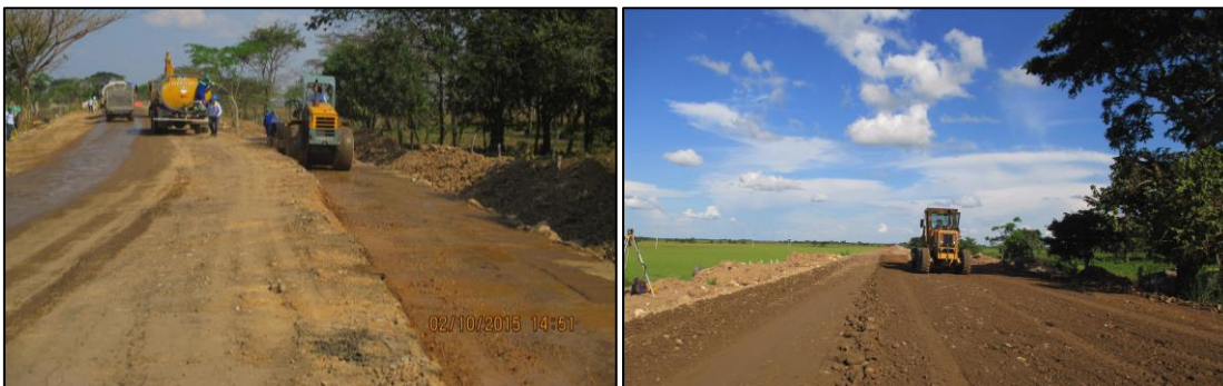
Imagen 6. Proceso constructivo para ampliación de terraplén. a) Excavación para ampliación de terraplén. b) Instalación de material de río sobre material granular existente (espesores iguales o mayores a 40cm)
