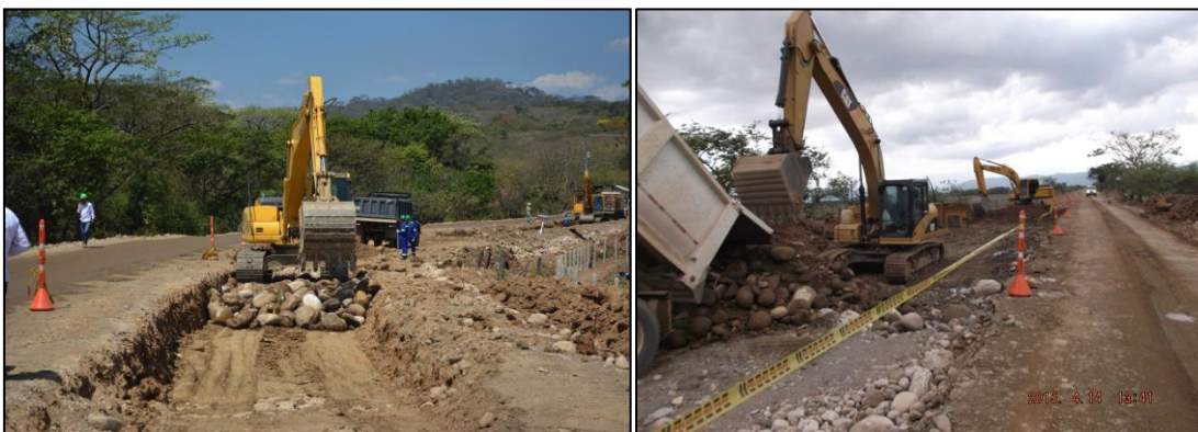
Imagen 5. Excavación para retiro de material arcilloso y remplazo con material de río sin clasificar.
