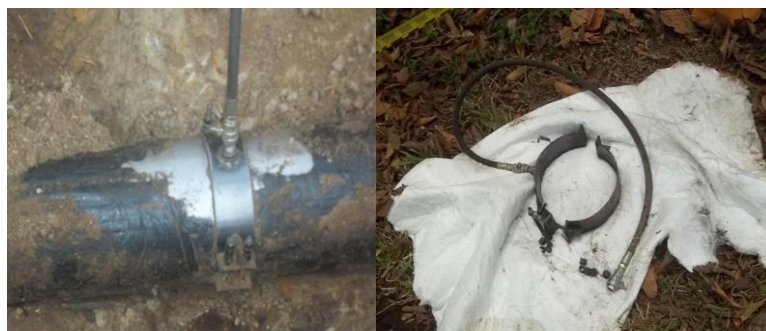
Ilustración 7. Instalación de válvulas ilícitas
