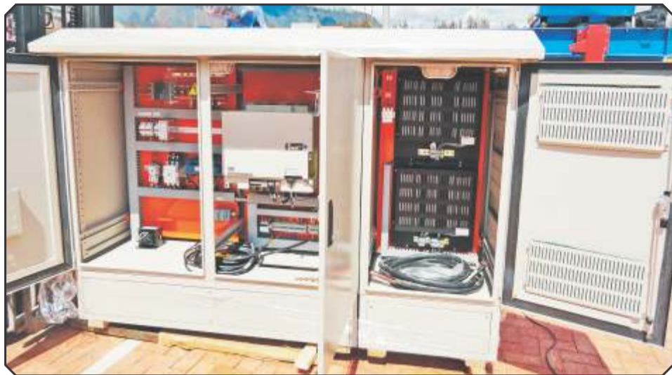
El gabinete donde reposa el componente electrónico del equipo es fácilmente desmontable
