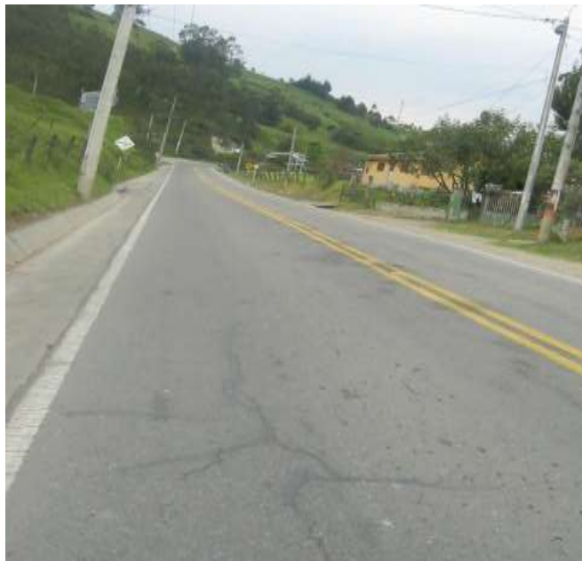
Fisura Longitudinal y transversal Ubicación K18+000 Carril Izquierdo Autor: MV JM
