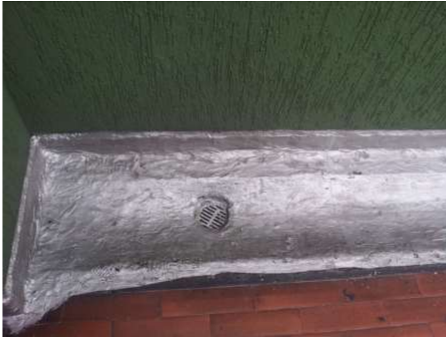
Ilustración 56 Canal de aguas lluvias - balcón
