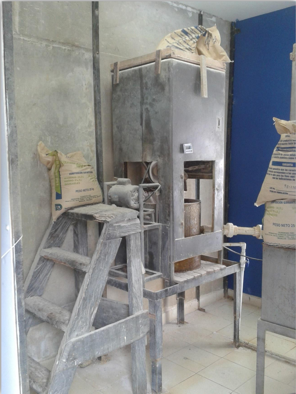
Foto 12: Dosificador Sulfato de Aluminio
