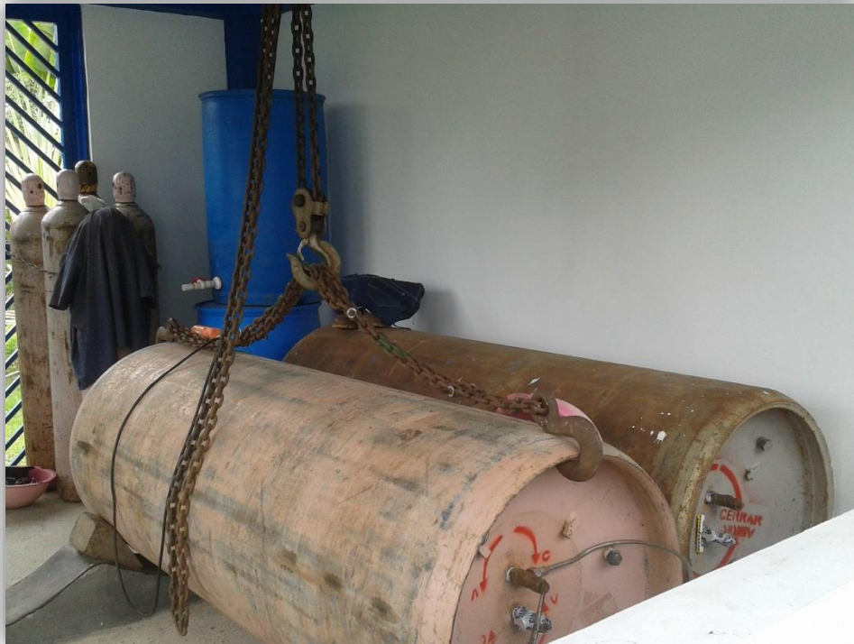
Foto 19: Sala de Cloración
