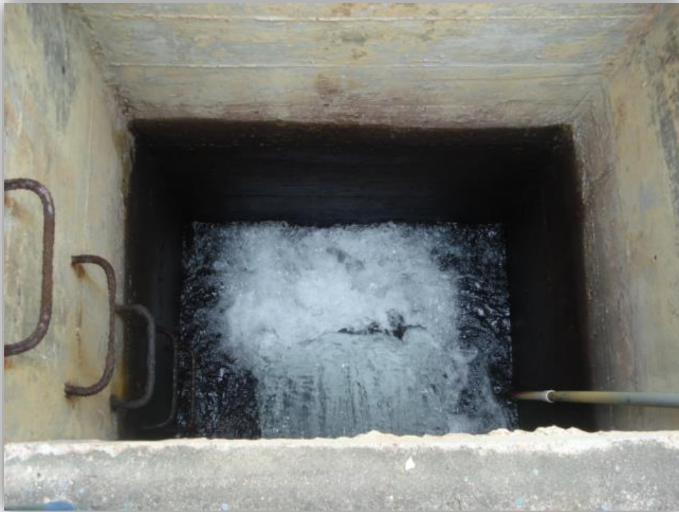
Foto 22: Conducto de Cloración
