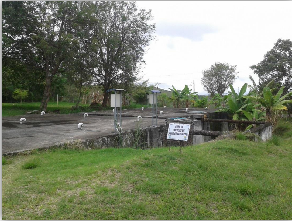
Foto 23: Área Tanques de Almacenamiento
