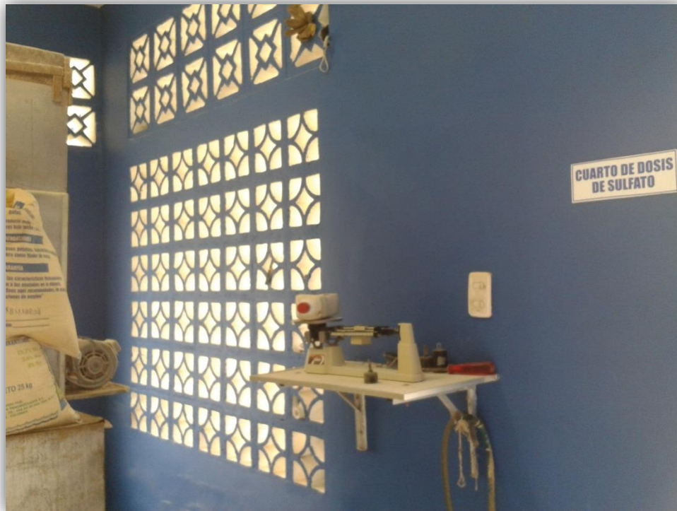
Foto 11: Cuarto de dosificación de coagulante
