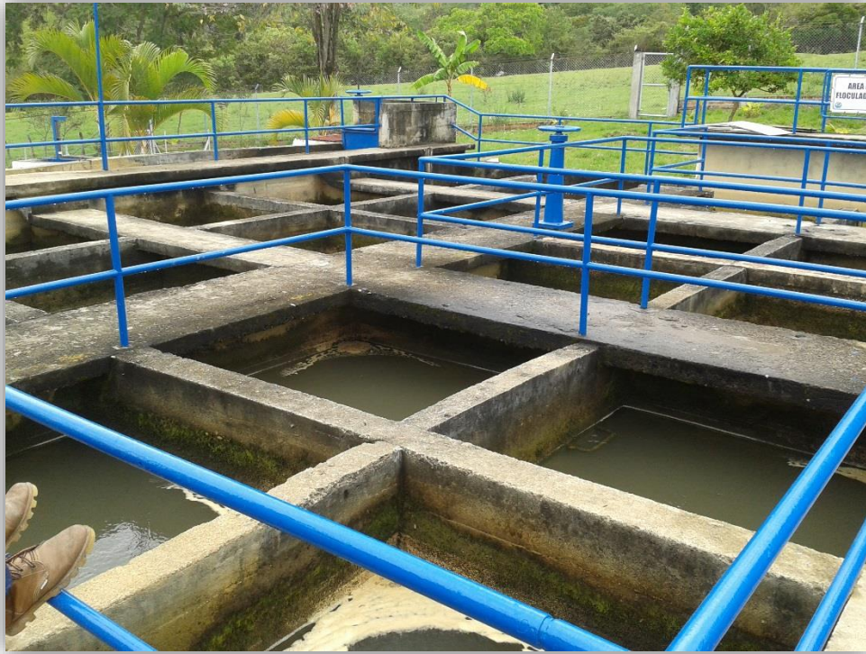
Foto 15: Área de Floculación
