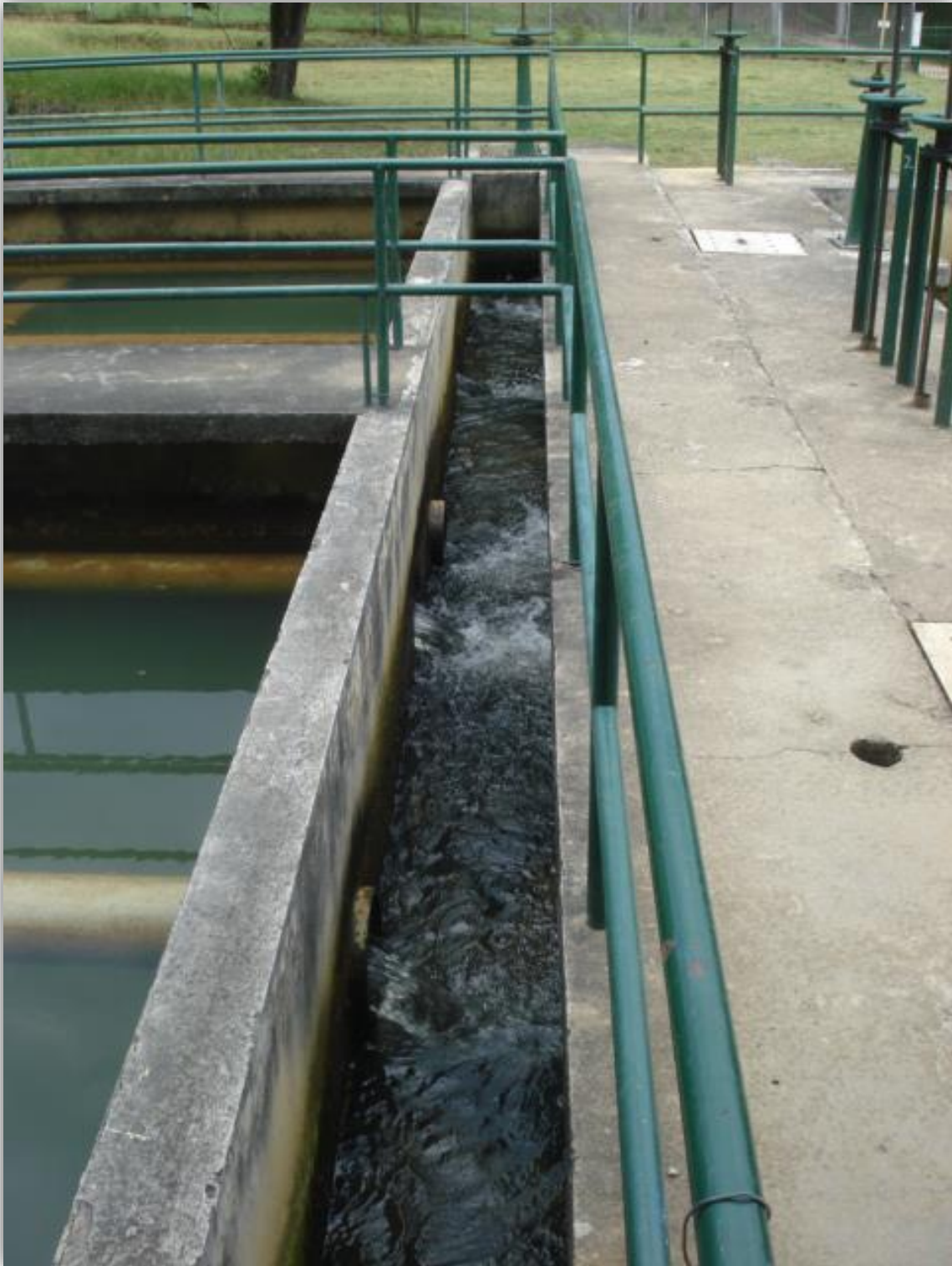
Foto 17: Canal de reparto a Filtros
