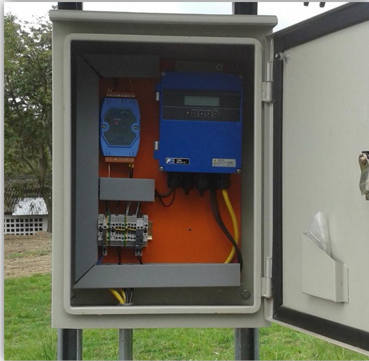
Foto 24: Medidores de Caudal tanques de almacenamiento
