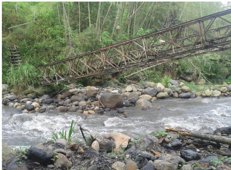
Figura 32. Puente caído sector La Juanita
