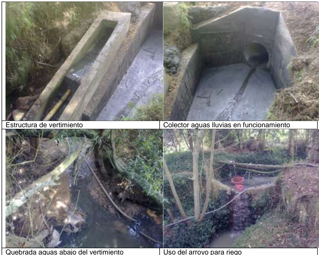
Figura 10. Punto de vertimiento quebrada Montecillo
