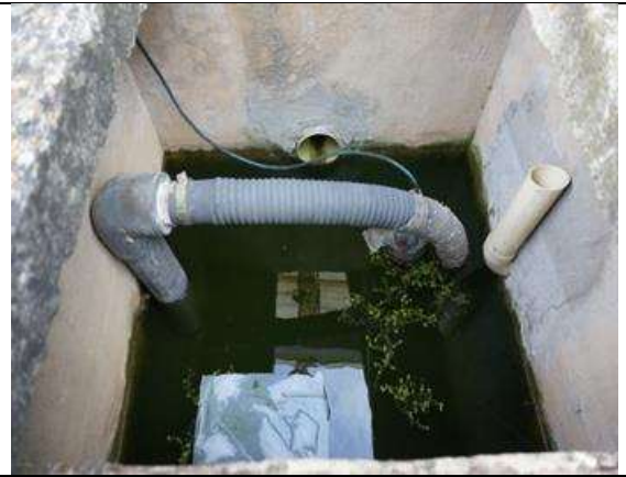
Bomba de lixiviados
