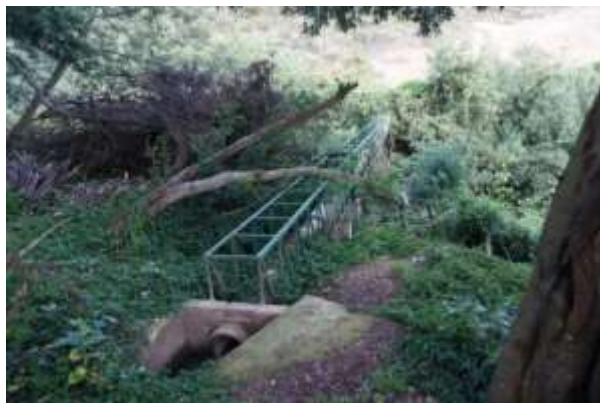
Figura 5. Paso elevado colector PVC sobre la quebrada Embala
