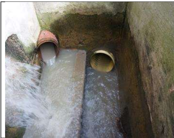
Ingreso del agua residual y aliviadero
