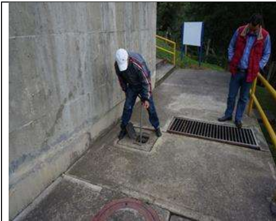
Válvula para recirculación de lodos
