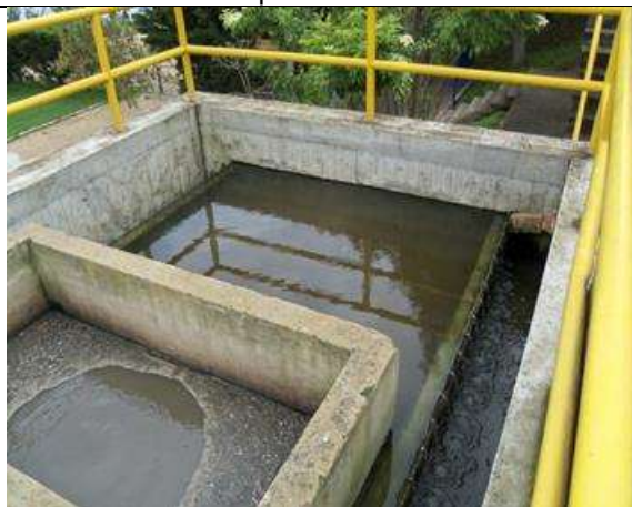
Sedimentador y clarificador
