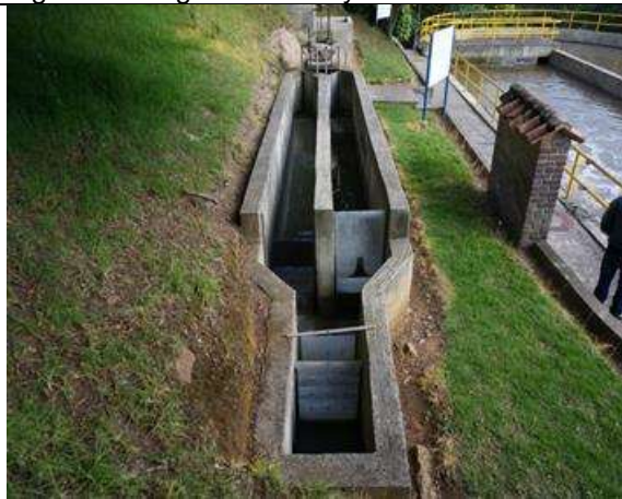
Desarenadores en paralelo
