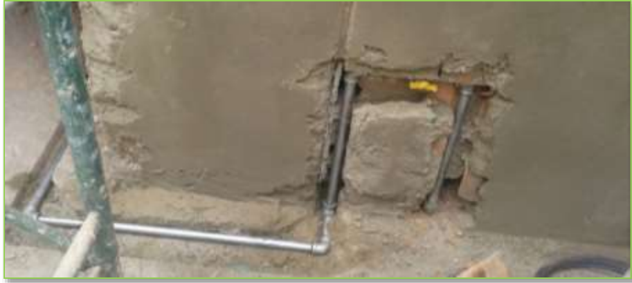
Figura 5. Red tubería de Gas- Ubicación de registro
