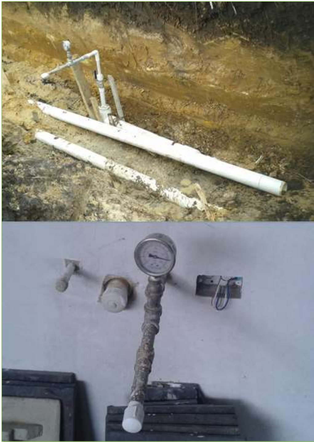
Figura 16. Prueba de presión Red principal de suministro 3" (Superior) Prueba de presión Red hidráulica casa en obra blanca (Inferior)
