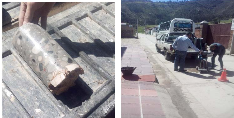
ILUSTRACIÓN 13: EXTRACCION DE NUCLEO 4 CALLE 4 ENTRE CRA 3 Y 4
