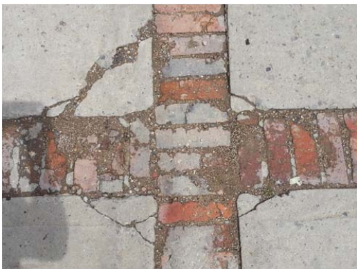
ILUSTRACIÓN 15: BACHEO Y FISURAS DE ESQUINA CALLE 4 ENTRE CRA 3 Y 4
