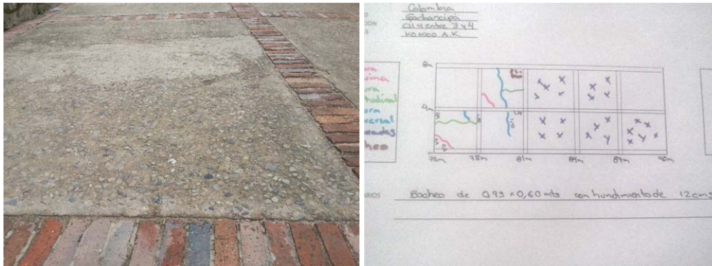
ILUSTRACIÓN 11: BACHES Y PULIMENTO EN LA CALLE 6 ENTRE CRA 3 Y 1
