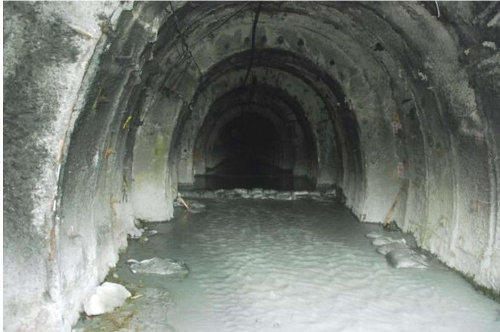
Figura 4. Filtración quebrada La Gata en el Túnel de la línea.
