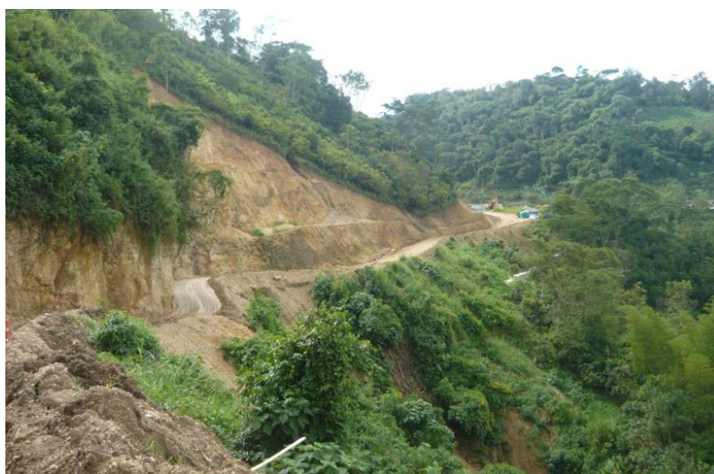
Figura 12 Deslizamientos debido al invierno Fuente: Propia
