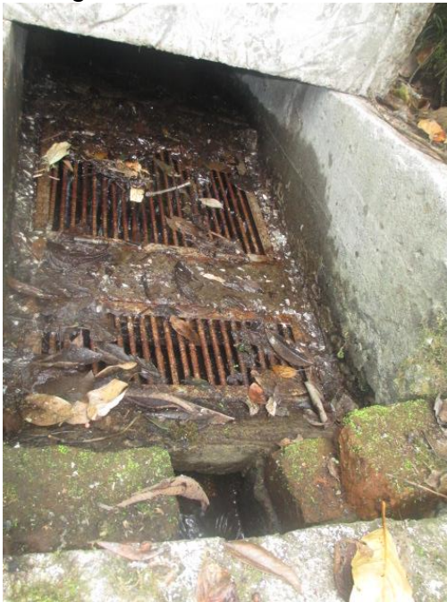
Ilustración 15 Fotografía - Falta de mantenimiento del sistema
