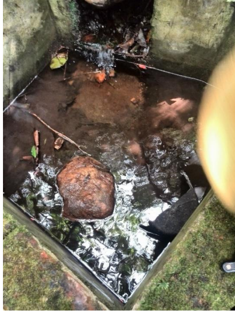
Ilustración 14 Fotografía - Mal estado del sistema
