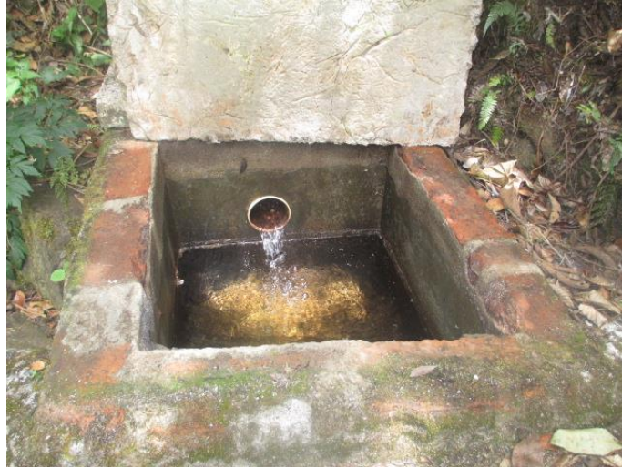
Ilustración 16 Fotografía - El desarenador no cumple su función
