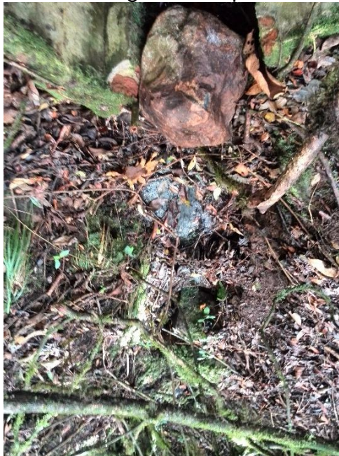
Ilustración 11 Fotografía - Captación deficiente
