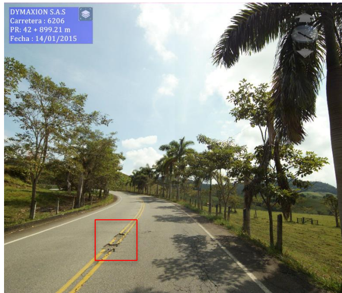
Figura 3. Daños en el pavimento flexible PR 42+899
