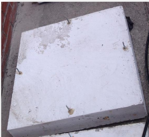
Figura 16. Perforaciones en losa
