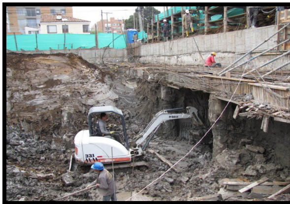
Ilustración 12 Pilotes que necesitan ser descabezados en obra. Fuente www.constructorasanfrancisco.com
