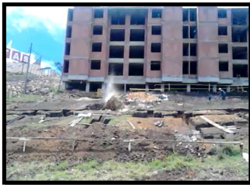
Ilustración 29. Proyecciones producto del exceso de material explosivo. Fuente propia
