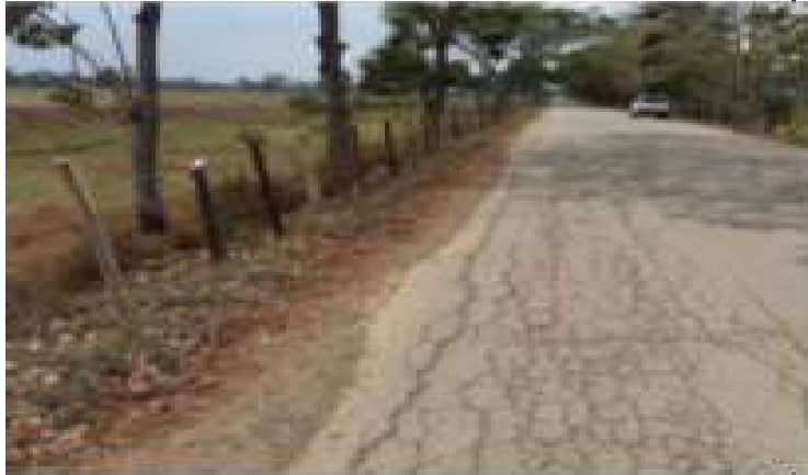
Figura N° 4. Estado de la vía K34+370 – K37+600 Fisuras Longitudinales de Borde Desgaste Superficial.
