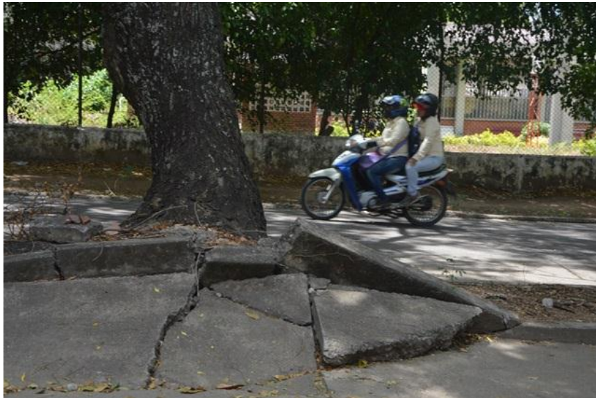
Los accidentes de motociclistas son continuos debido al estado de la calle.
