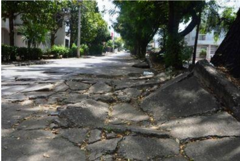
En la calle 19 entre carreras 32 y 35 del barrio Buganviles las raíces de los árboles levantaron la cementación de la vía.
