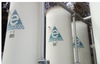
Fotografía 2. Tanques de almacenamiento hídrico.
