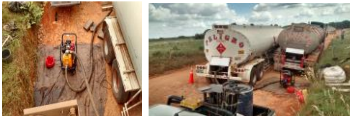
Ilustración 4 La imagen enseña el modo artesanal para el hurto de fuel oil en carretera; con lo que se ocasionan grandes derrames sobre las vías y posteriormente con las lluvias va a las fuentes hídricas. Boletín interno Departamento de Policía Casanare. (Casanare., 2016)
