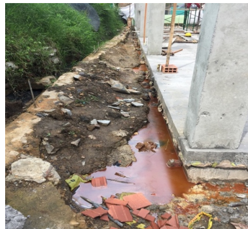
Figura 33. Acumulaciones de agua con grasas.
