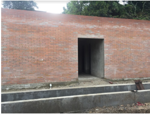
Figura 44. Zona de baños sin instalación de aparatos .
