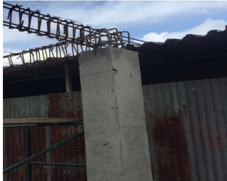
Figura 34. Inconveniente colocación de acero.
