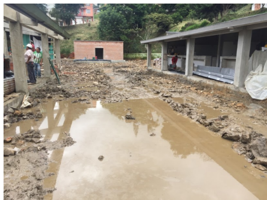
Figura 49. Problemas de inundación en la obra.
