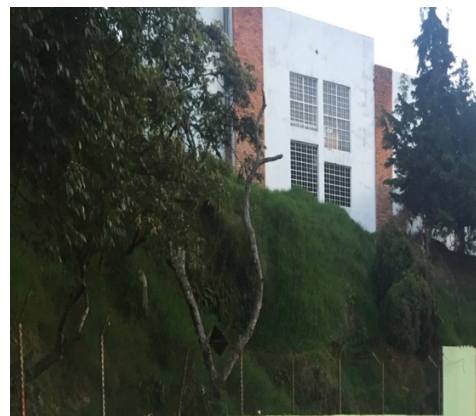
Figura 20. Problemas deslizamiento talud.
