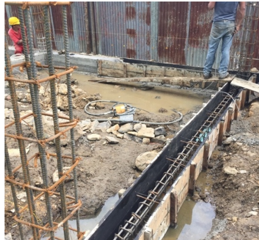
Figura 29. Acumulaciones de agua área cocinas.
