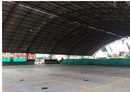
Figura 52. Placa faltante zona comercial terminada.
