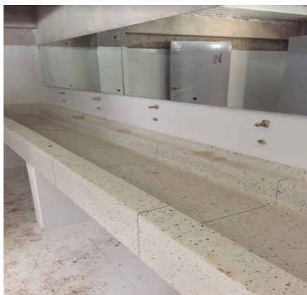
Figura 53. Aparatos baños sin instalar.
