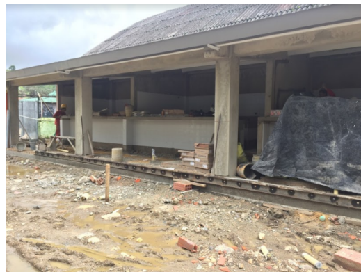
Figura 54. Acabados zona de cocinas y baños faltantes.
