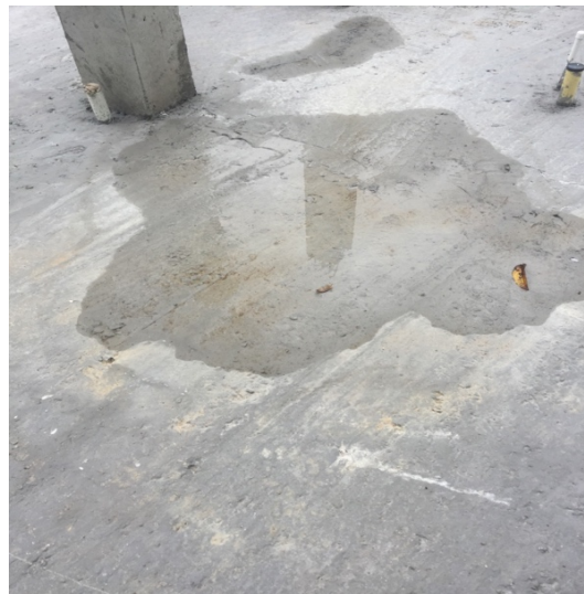
Figura 25. Filtraciones de agua en la placa de los baños.
