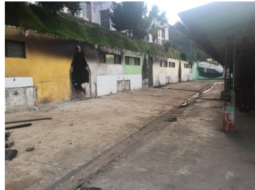
Figura 14. Estado inicial muro sin cimentar.
