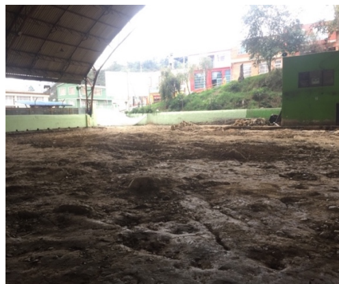
Figura 18. Estado placa zona comercial.
