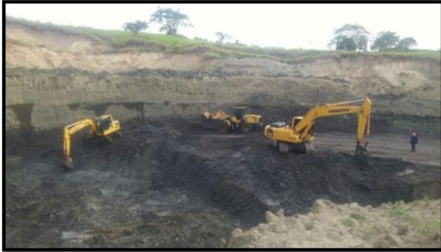
Fig. 3. Explotación a cielo abierto mina de Asfaltita de Norcasia, Caldas Fuente: Tomada de [13].
