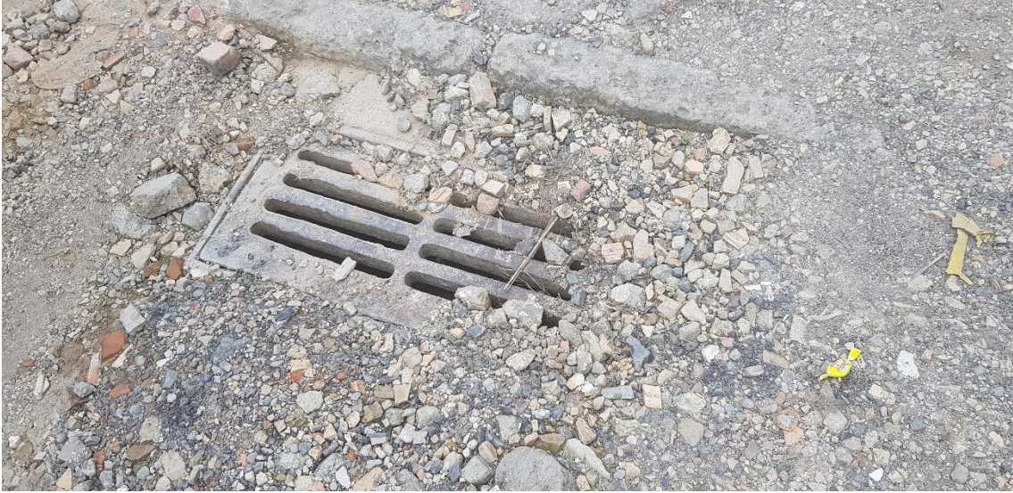
Figura 8. ARRASTRE DE MATERIALES HACIA LAS OBRAS DE DRENAJE
