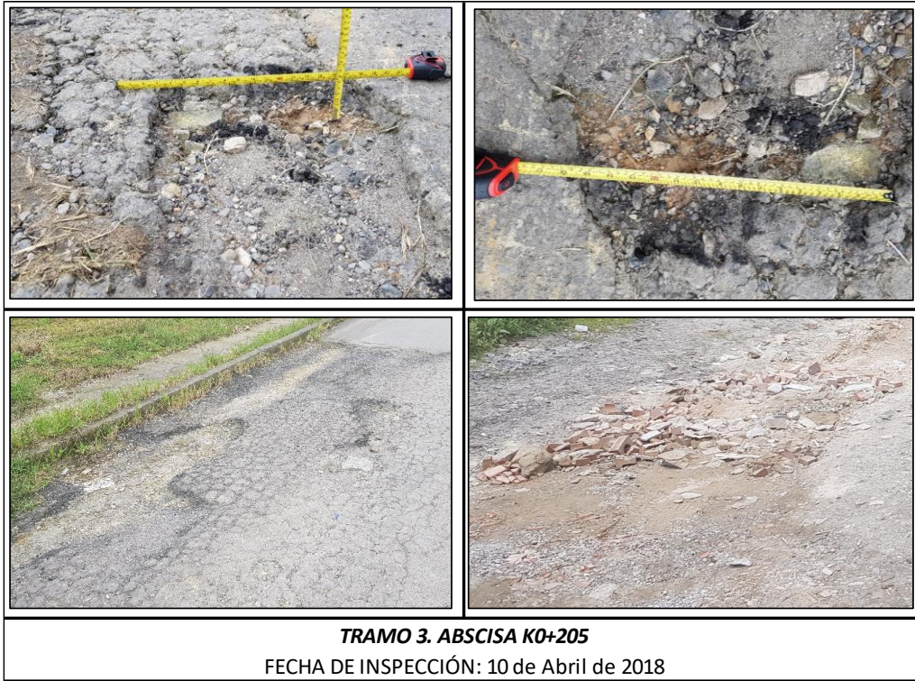
Figura 6. DAÑO TIPO HUECO Fuente: Propia.
