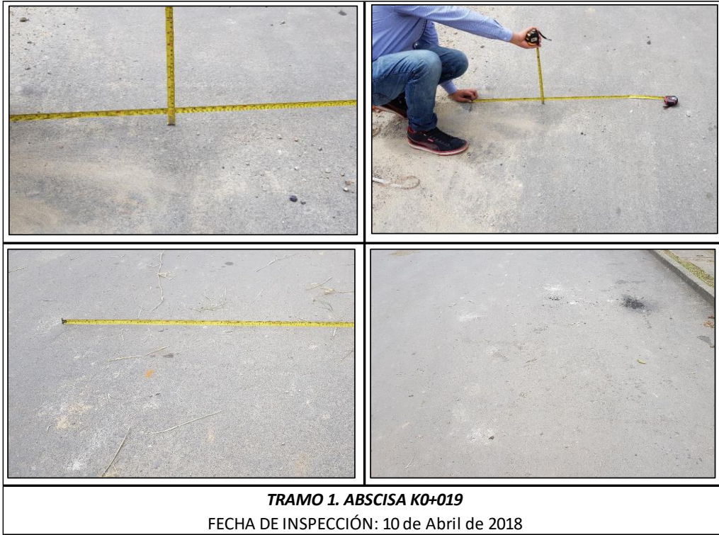
Figura 4. DAÑO TIPO HUNDIMIENTO Fuente: Propia.
