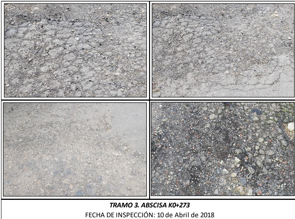
Figura 7. DAÑO TIPO DESPRENDIMIENTO DE AGREGADO GRUESO Fuente: Propia.
