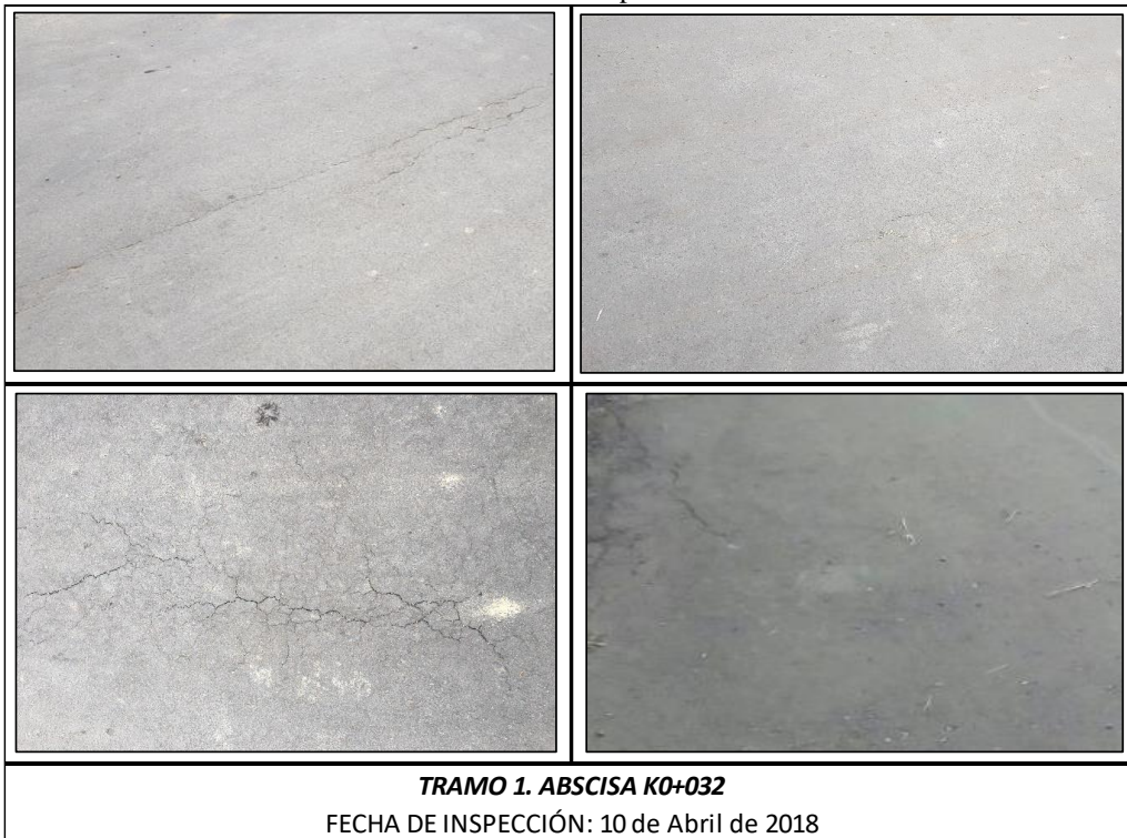
Figura 5. DAÑO TIPO GRIETAS LONGITUDINALES Y TRANSVERSALES Fuente: Propia.
