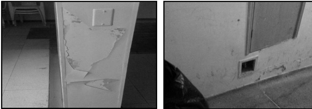
Figura 2. Problemas de humedad primer piso y sótano. Fuente: Rodríguez Ardila, 2013.
