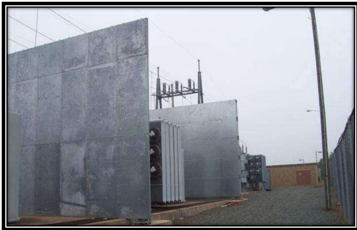
Imagen 14. Muros corta fuego
