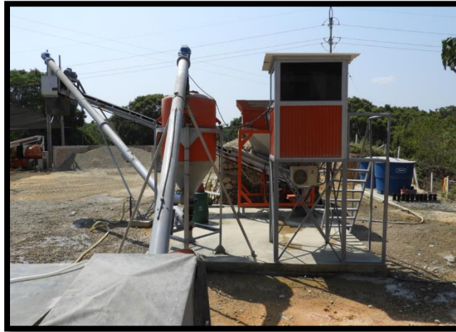
Figura 6. Planta de concreto WAMCOL SAS (2).
