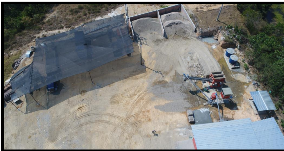
Figura 5. Planta de concreto WAMCOL SAS (1)
