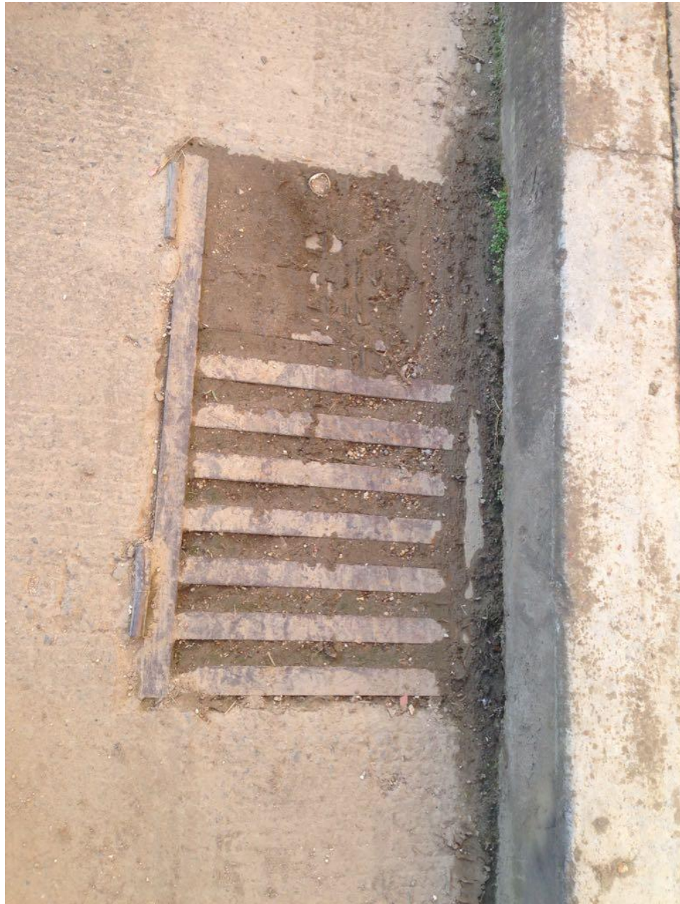
Ilustración 8: Sumidero en estado de Deterioro
