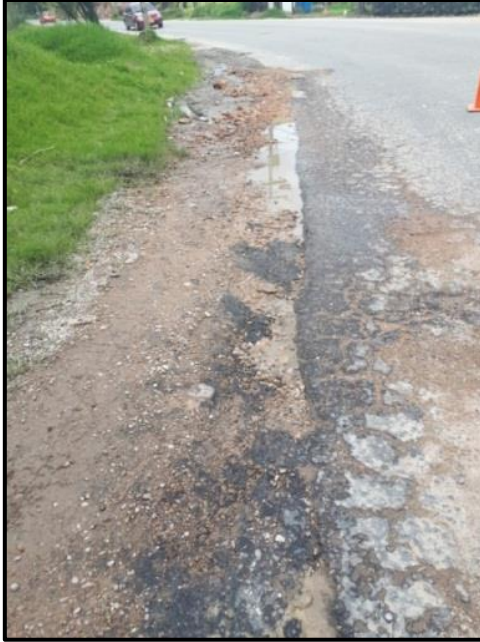
Imagen 5 Estado Actual de la Vía FUENTE: PROPIA
