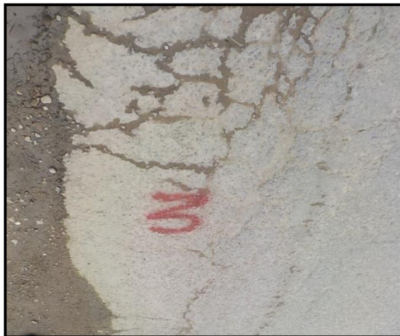
Imagen 11 Falla No 3 Fisura en Borde
