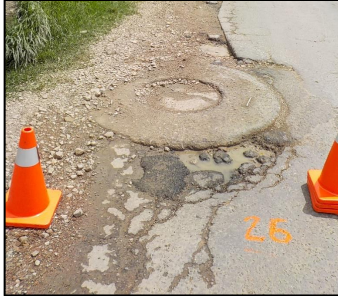
Imagen 22 Falla No 26 Bache FUENTE: PROPIA
