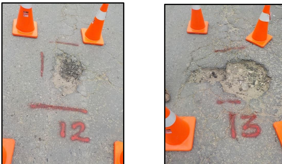
Imagen 19 Falla No 12 y 13 Bache FUENTE: PROPIA
