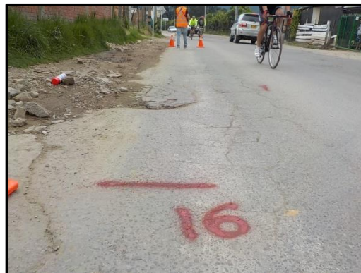
Imagen 23 Falla No 16 Fisura en bloque FUENTE: PROPIA
