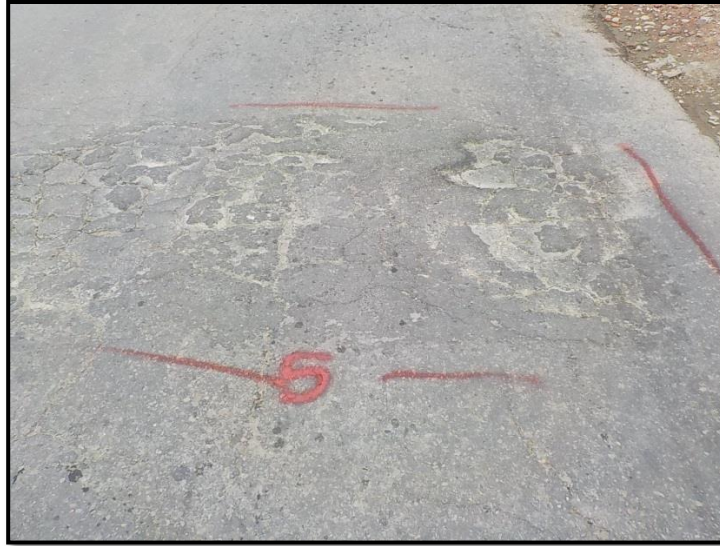
Imagen 10 Falla No 5 Descascaramiento
