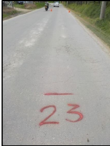
Imagen 16 Falla No 23 Piel de cocodrilo FUENTE: PROPIA
