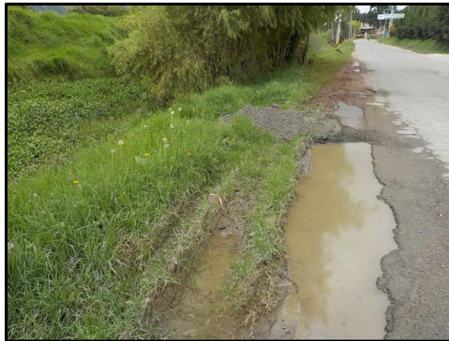
Imagen 6 Estado Actual de la Vía FUENTE: PROPIA
