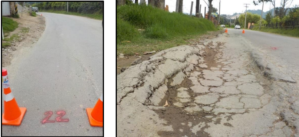
Imagen 18 Falla No 22 y 24 Hundimiento FUENTE: PROPIA
