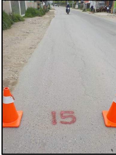
Imagen 14 Falla No 15 Fisura Longitudinal FUENTE: PROPIA
