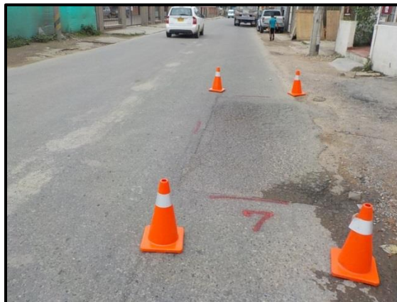
Imagen 15 Falla No 7 Piel de cocodrilo FUENTE: PROPIA
