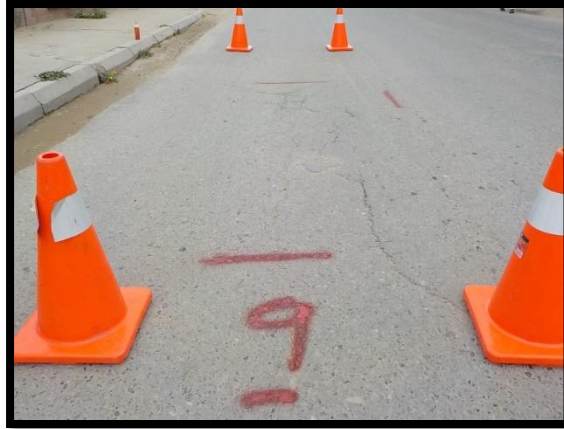
Imagen 12 Falla No 9 Fisura en Borde FUENTE: PROPIA
