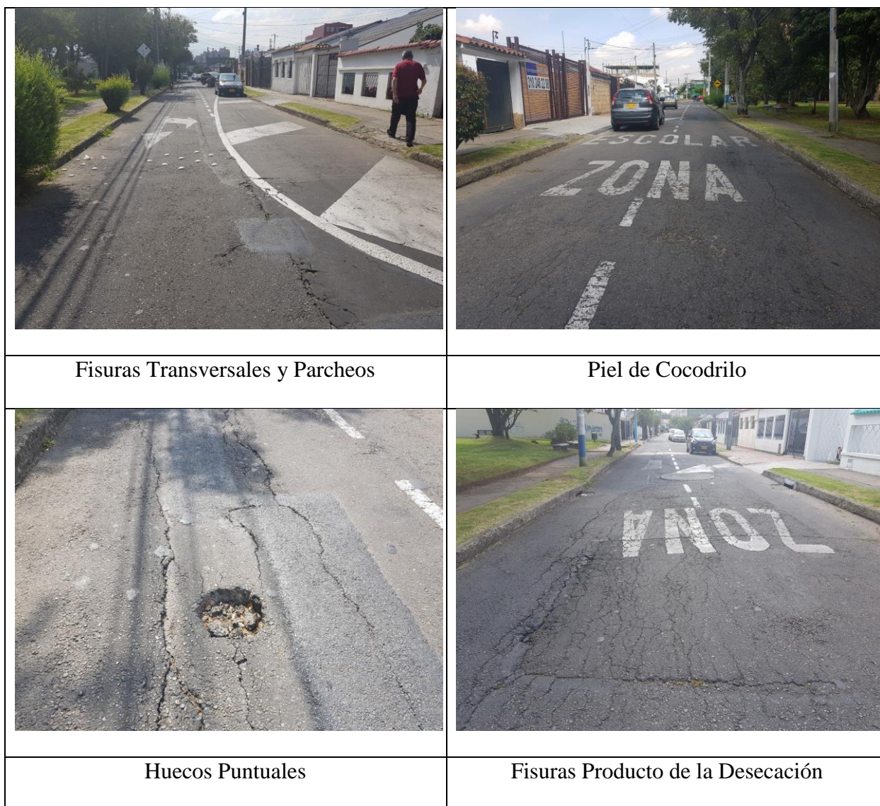
Ilustración 7 Estado del Segmento Vial
