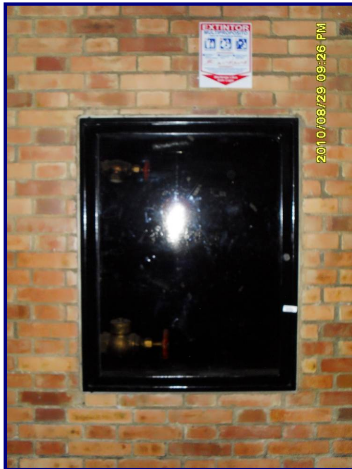
Figura 16. Gabinete contra incendio existente. Piso 3. Edificio B
