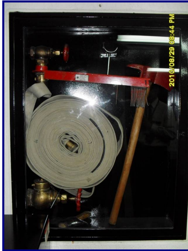
Figura 9. Gabinete contra incendio existente. Sótano. Edificio Administrativo A.
