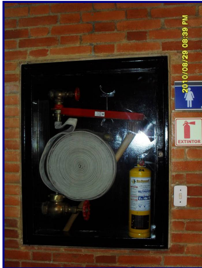
Figura 11. Gabinete contra incendio existente. Piso 2. Edificio Administrativo A
