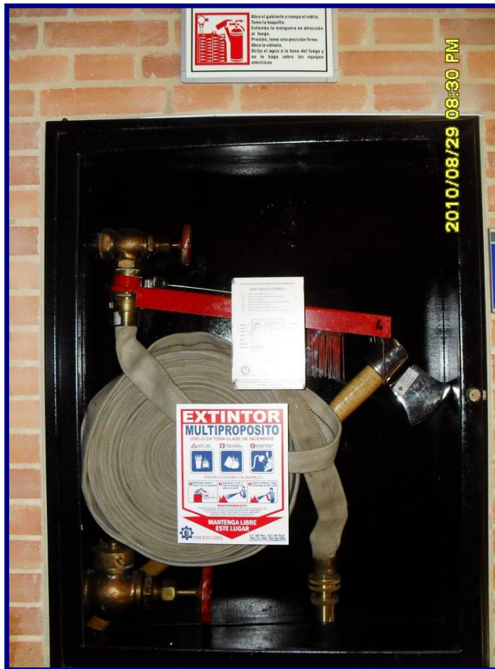
Figura 12. Gabinete contra incendio existente. Piso 3. Edificio Administrativo A
