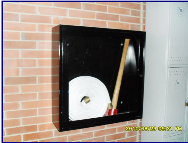
Figura 24. Gabinete contra incendio sin dotación alguna. Ubicado en el sótano del Edificio "E".
