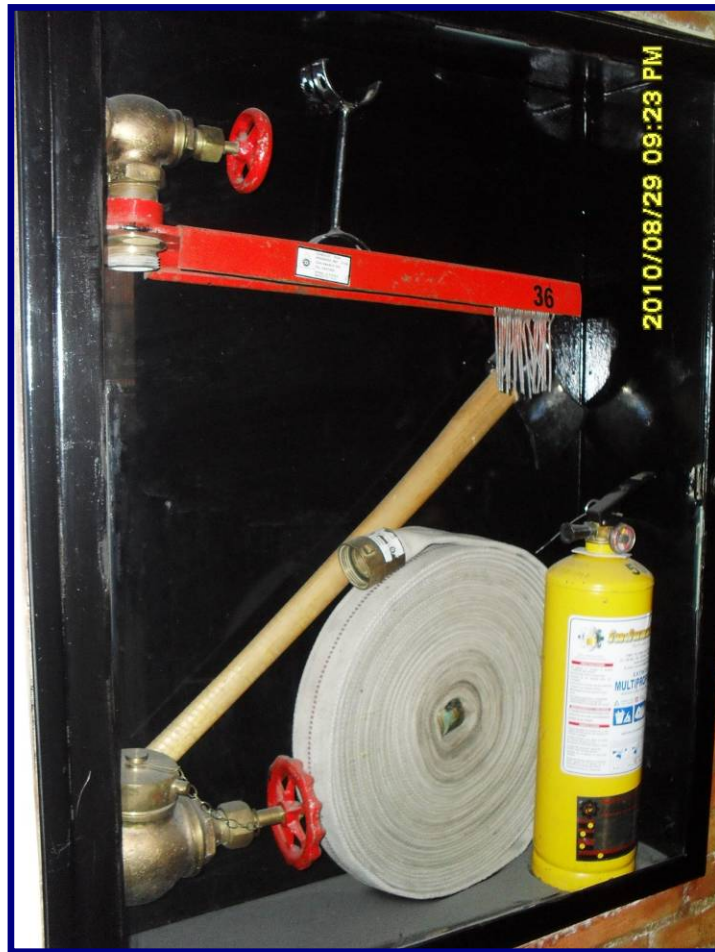
Figura 18. Gabinete contra incendio existente. Piso 2. Edificio "C"
