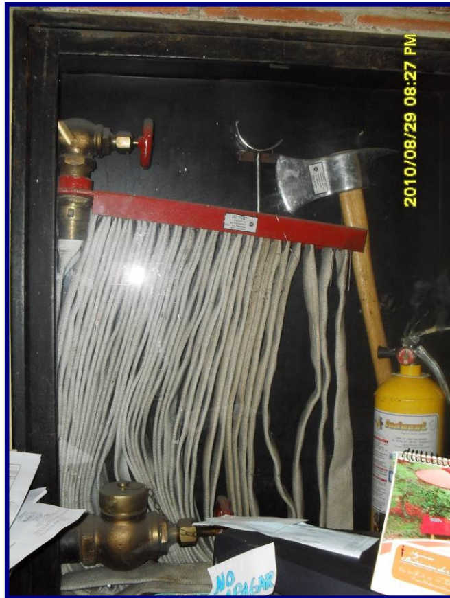
Figura 10. Gabinete contra incendio existente. Piso 1. Edificio Administrativo A.
