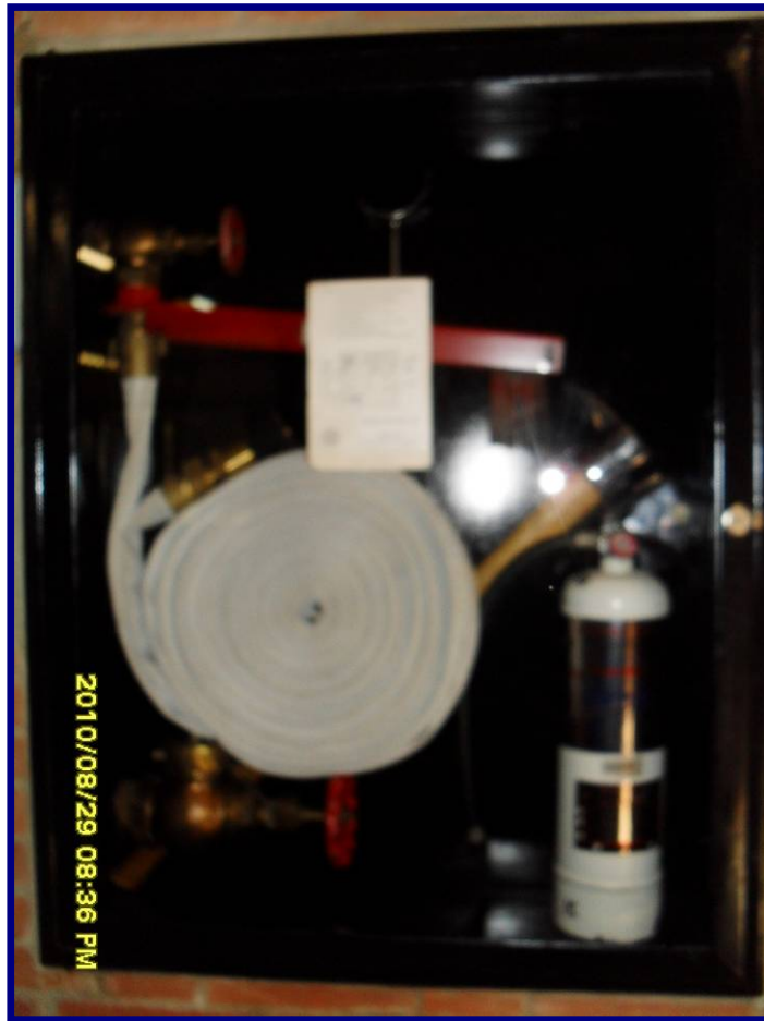
Figura 13. Gabinete contra incendio existente. Piso 4. Edificio Administrativo A
