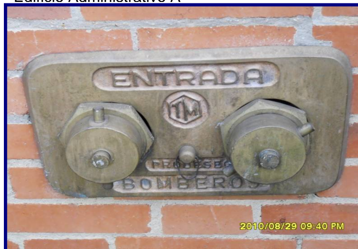
Figura 25. Conexión a bomberos existente. Piso 1. Edificio Administrativo A
