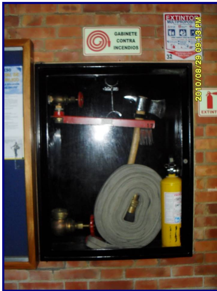
Figura 14. Gabinete contra incendio existente. Piso 1. Edificio B
