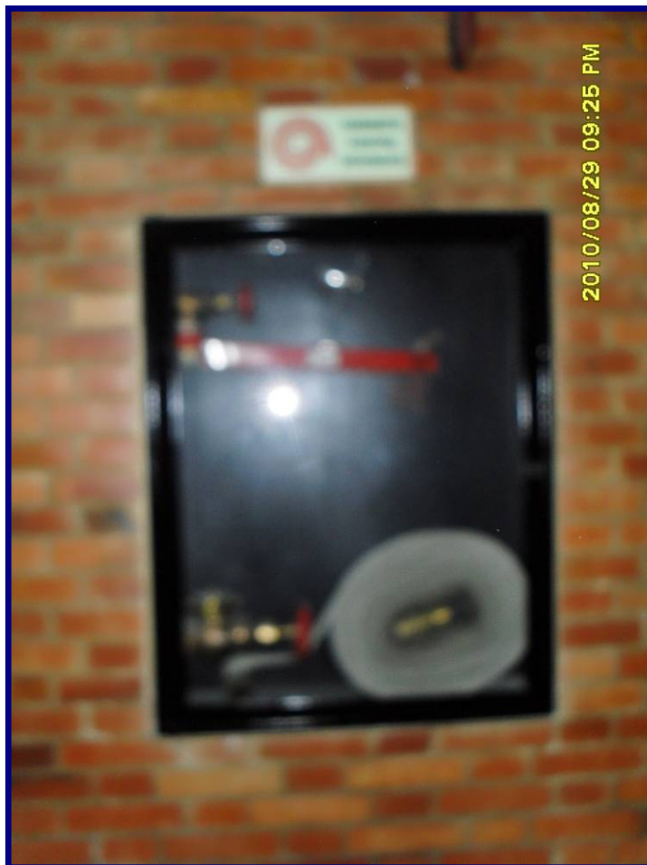
Figura 15. Gabinete contra incendio existente. Piso 2. Edificio B
