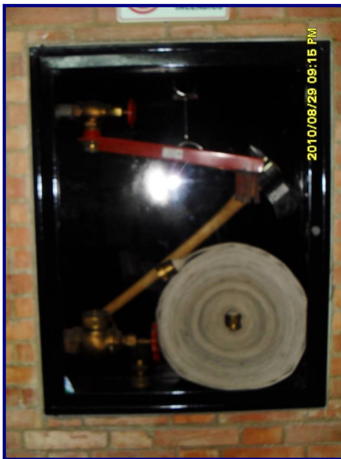
Figura 17. Gabinete contra incendio existente. Piso 1. Edificio "C"
