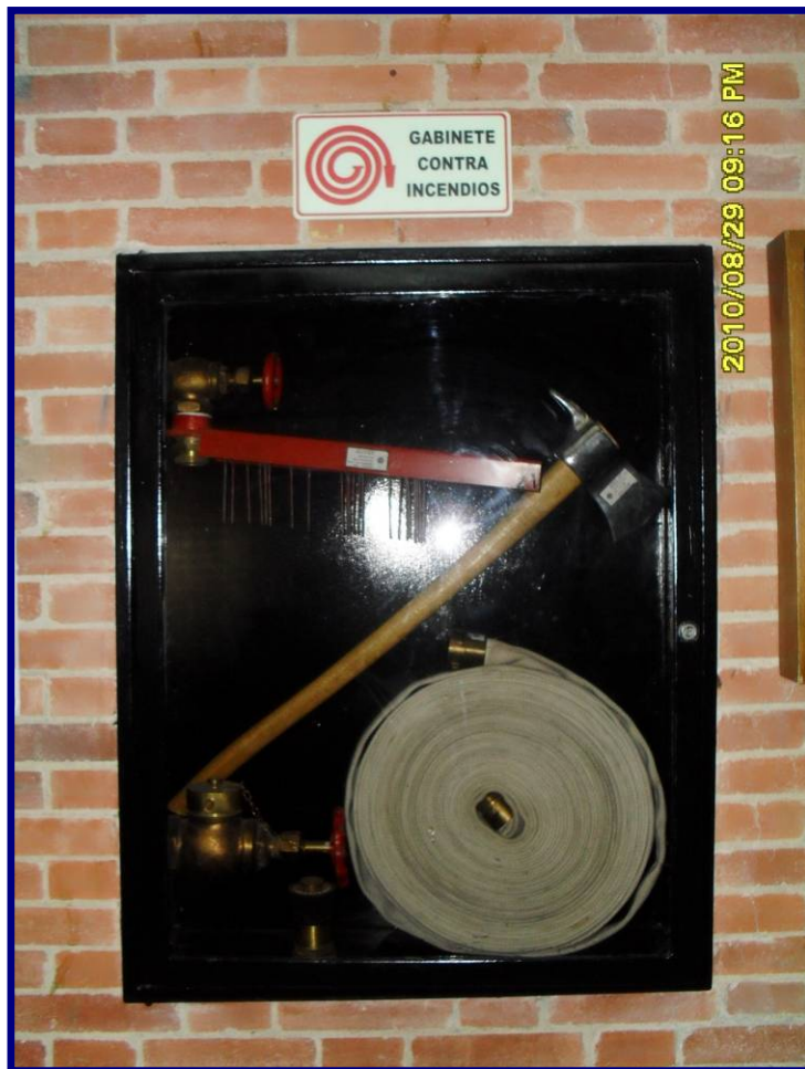
Figura 21. Gabinete contra incendio existente. Piso 1. Edificio "D"
