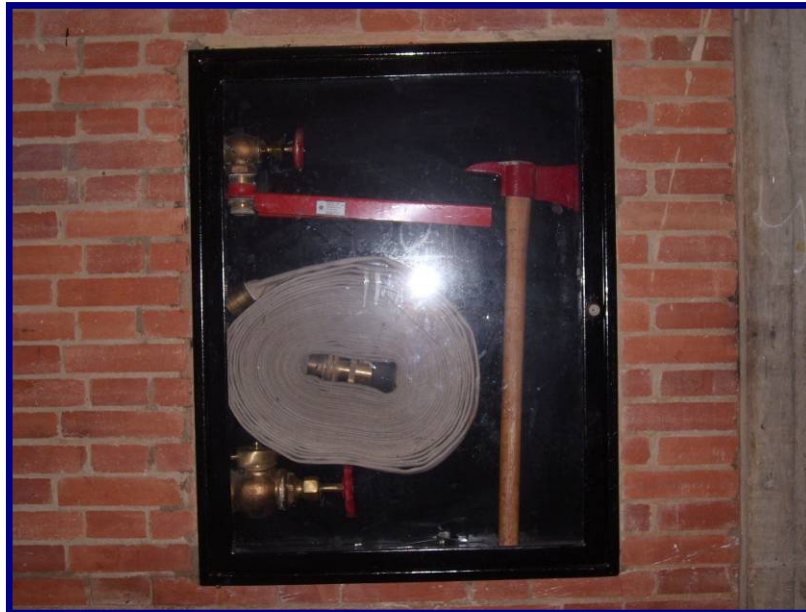
Figura 20. Gabinete contra incendio existente. Sótano. Edificio "D"
