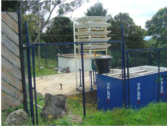
Vista general Tanque – Planta de Tratamiento 2
