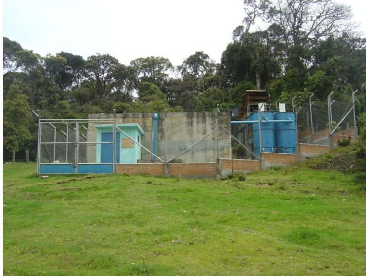
Vista general Tanque – Planta de Tratamiento 1
