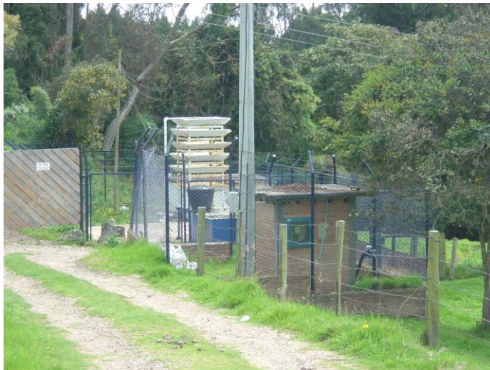
Vista general Tanque – Planta de Tratamiento 2, junto al Pozo
