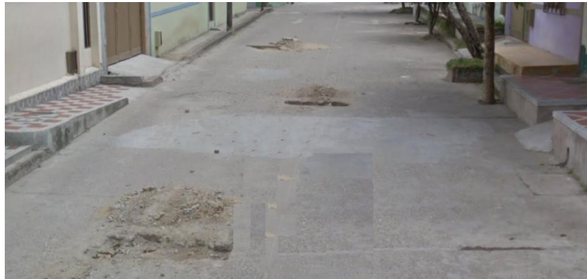
Ilustración 15: Problemática con mantenimiento de la vía Calle 16 – Carrera 8
