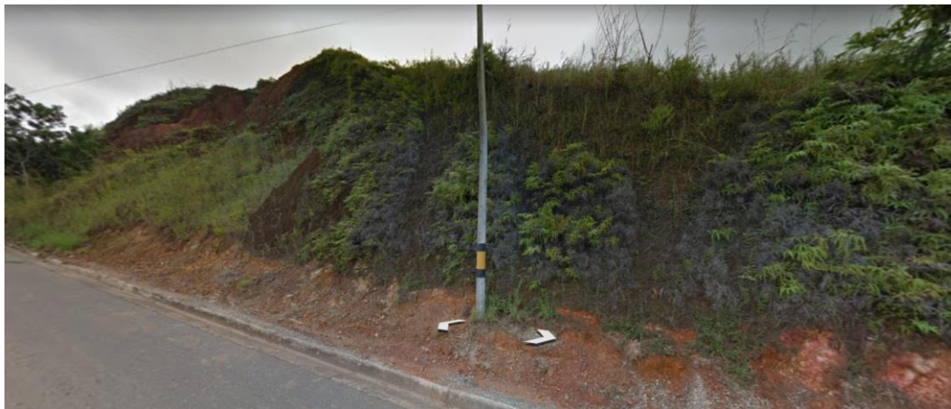
Figura 41. Talud K1+800 al Inicio del Sector. Socavación en el apoyo del talud. Google Earth 2020.
