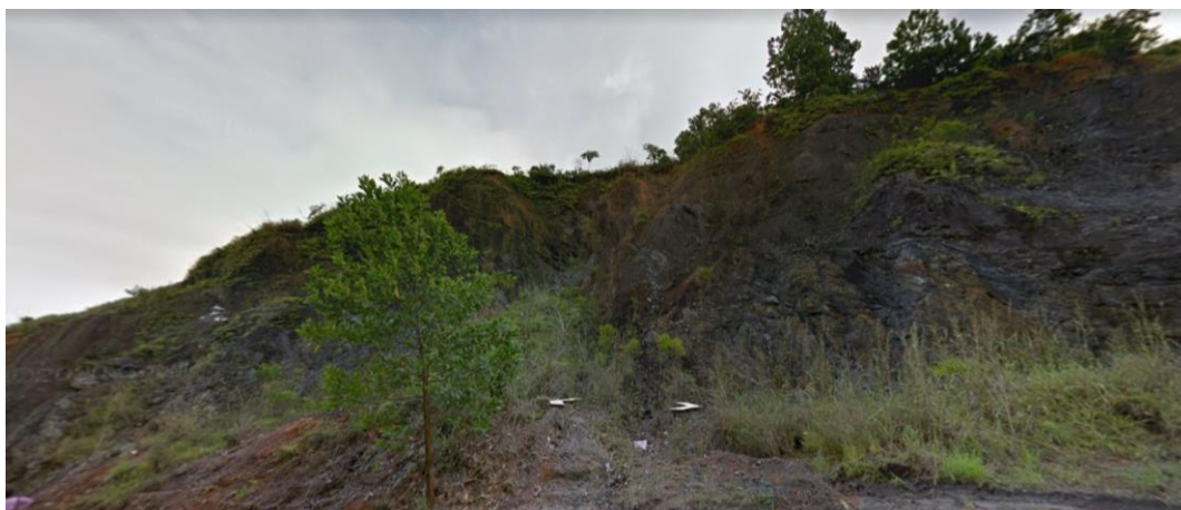
Figura 40. Talud Derecho K1+145 – K1+650 Desgaste del material en la Corona. Google Earth 2020.
