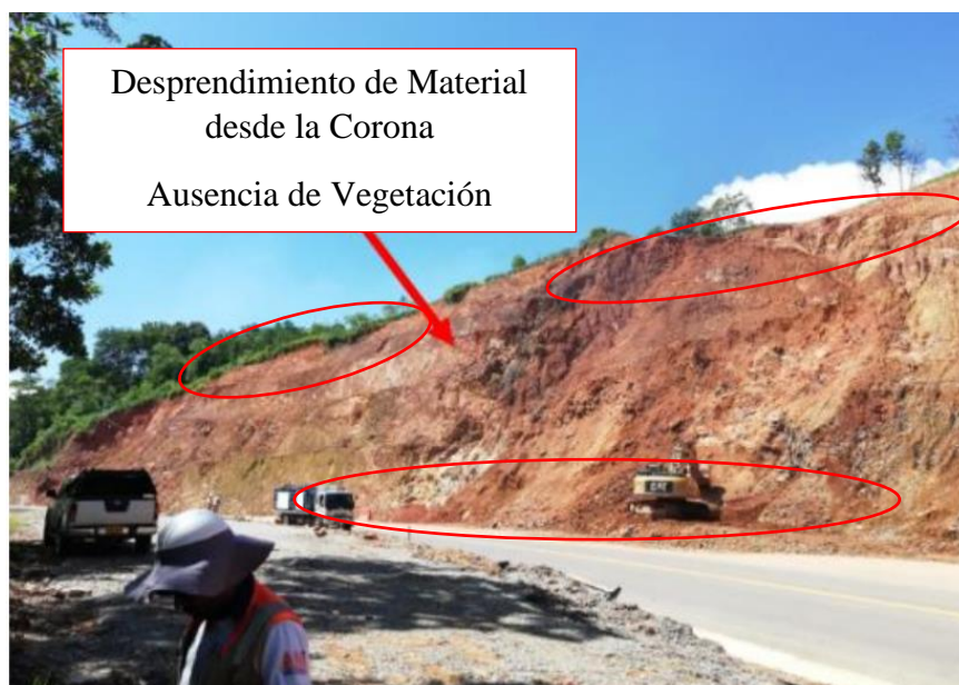
Figura 82. Sección Crítica entre K2+260 Unidad Funcional 2 Caucaasia – Zaragoza de Antioquia - Volumen V Estudio de Estabilidad y Estabilización de Taludes – 2015.
