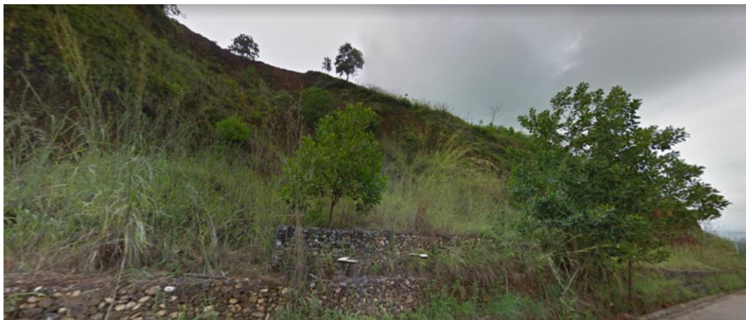
Figura 43. Talud K1+800 Perdida del material de Contención de revegetalización en la parte posterior a los gaviones al Final del Tramo. Google Earth 2020.
