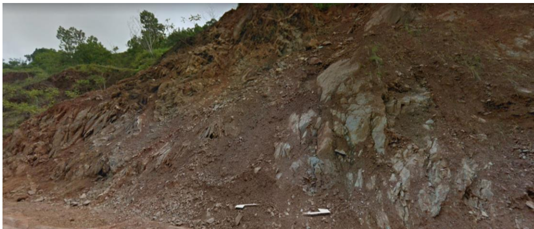
Figura 45. Talud K2+150. Movimiento de masas del Talud. Google Earth 2020.
