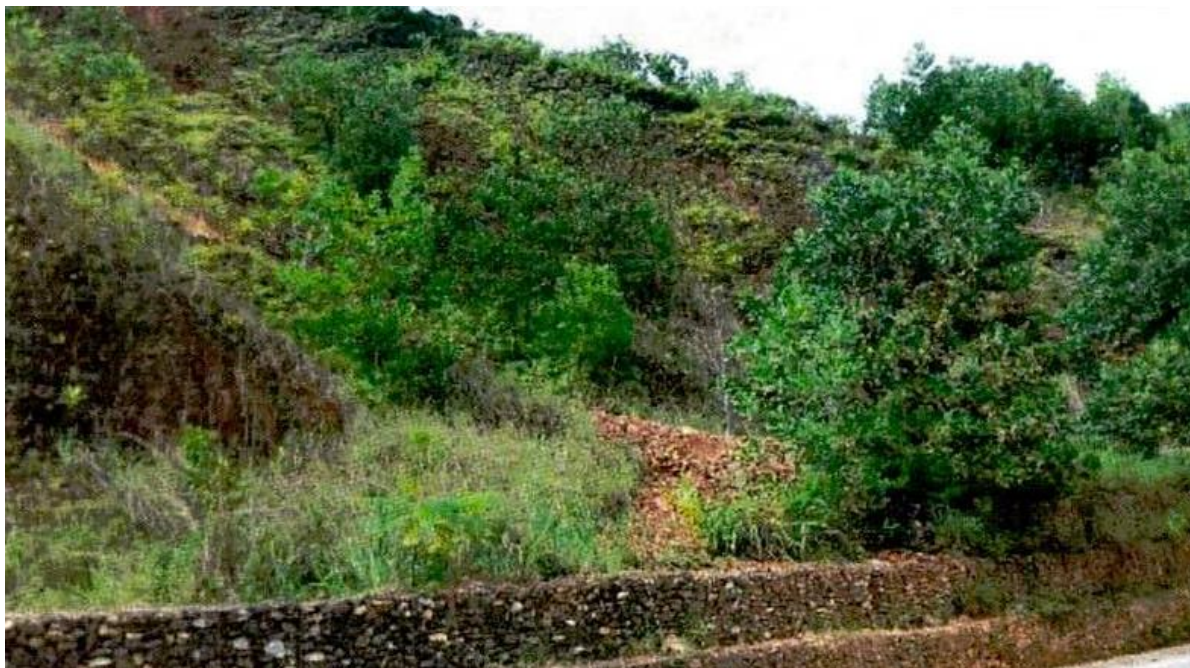
Figura 34. Talud K1+800 Deslizamiento detrás de los gaviones al Final del Tramo. Volumen V Estudio de Estabilidad y Estabilización de Taludes – 2015.
