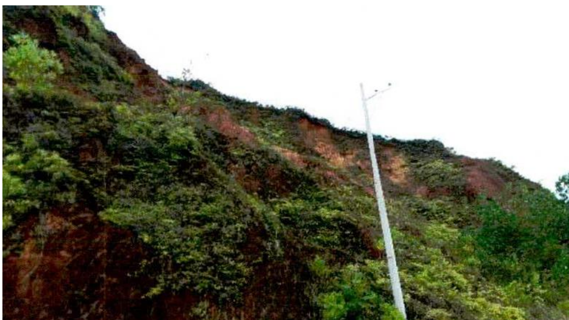
Figura 33. Talud K1+800 Escarpes de la Parte Alta del Talud. Volumen V Estudio de Estabilidad y Estabilización de Taludes – 2015.
