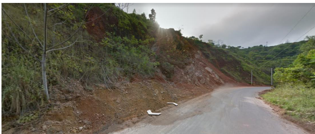
Figura 46. Talud K2+150. Sistema de Drenaje Deficiente. Google Earth 2020.
