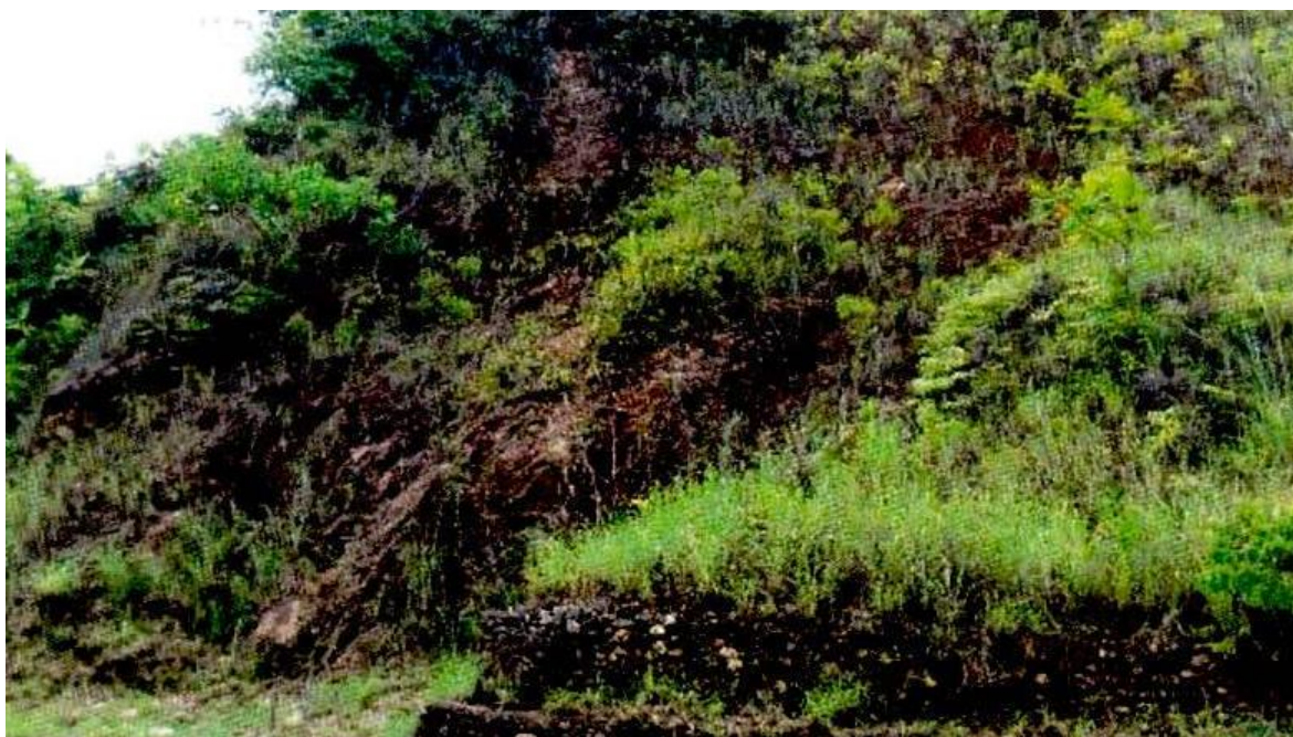
Figura 35. Talud K1+800 Cuarcitas Meteorizadas al Final del Tramo. Volumen V Estudio de Estabilidad y Estabilización de Taludes – 2015.
