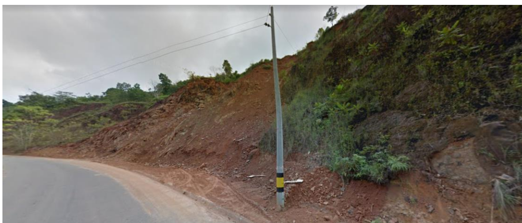
Figura 44. Talud K2+150. Incremento en el movimiento del Talud hacia la Vía. Google Earth 2020.
