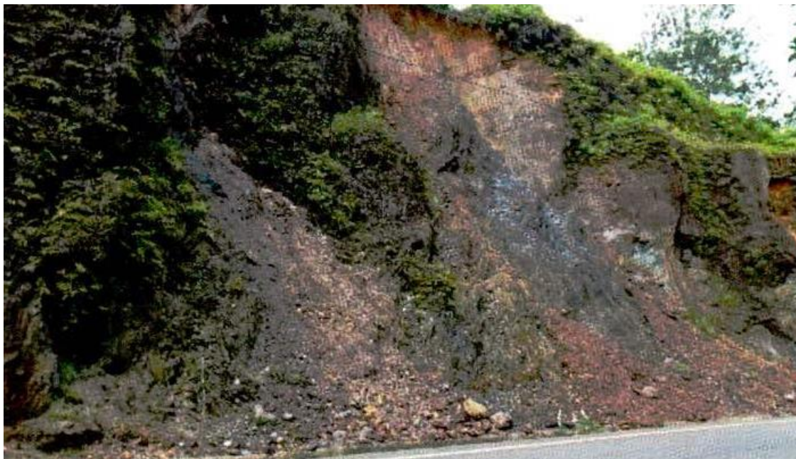
Figura 29. Talud Derecho K1+145 – K1+650. Volumen V Estudio de Estabilidad y Estabilización de Taludes – 2015.
