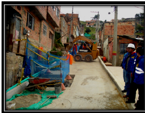
Foto 7 Pendiente de la vía y construcción del pozo de inspección donde se conecta el sumidero.
