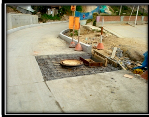
Foto 5 Se aprecia la magnitud del sumidero respecto al ancho de la vía.
