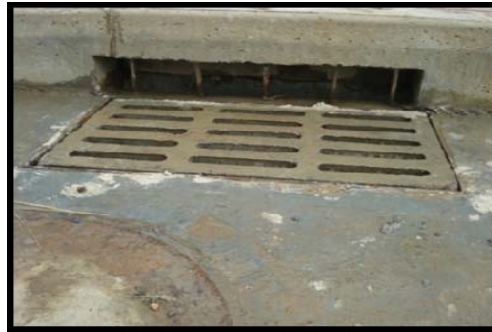
Foto 30. Sumidero Completamente Limpio Caudal Bajo.
