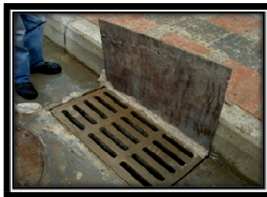
Foto 26. Sumidero Lateral Tapado.
