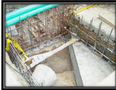
Foto 3. Vista general del Sumidero con Desarenador.
