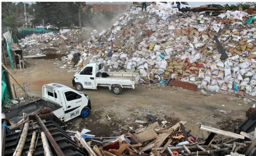
Figura 31 Situación de la escombrera de la carrera 50 en Cali.
