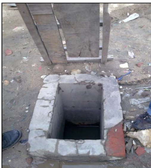
Figura 7 Caja De La Red De Distribución Actual Que Funciona Como Pozo En La Comunidad De Villa Clarín Planes De Manejo Integral De Recursos Hídricos En Comunidades De Desplazados En Colombia-Caso De Estudio Villa Clarín
