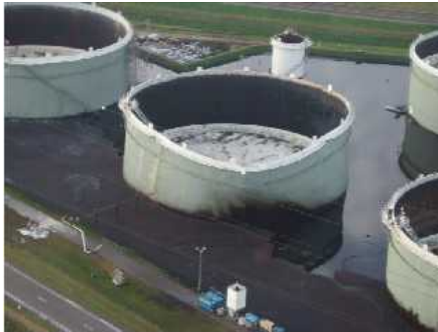
Foto 3. Colapso de estructura del tanque.
