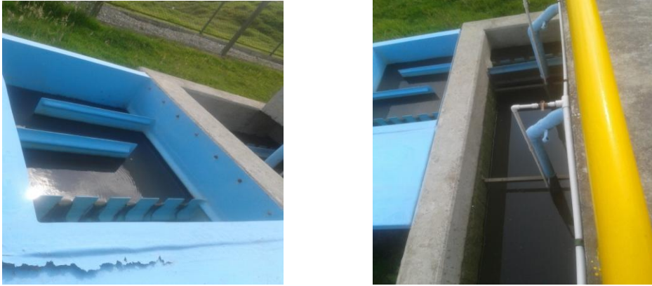
Figura5. Sedimentador secundario de la PTAR
