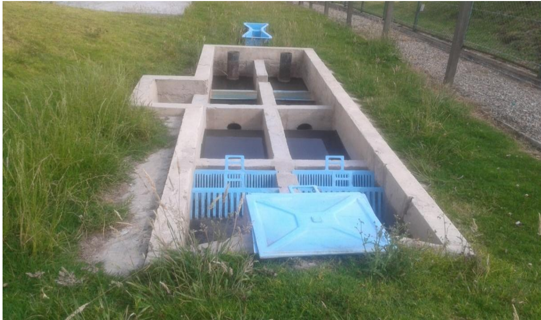
Figura 10. Entrada de agua a la Planta de tratamiento de agua residual;
