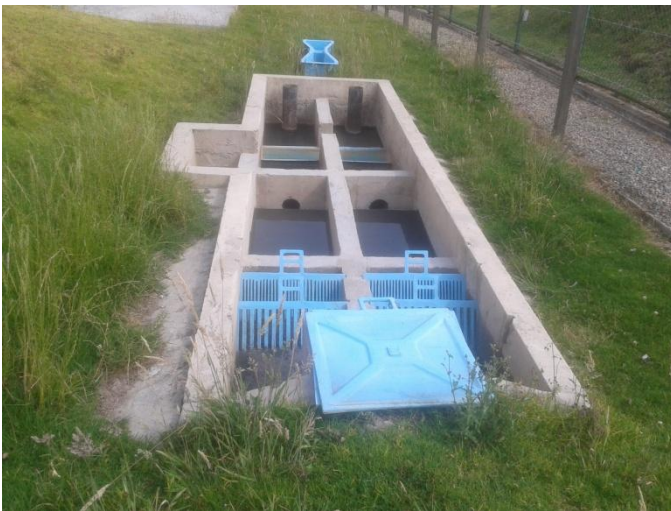
Figura 3. Sedimentador primario de la PTAR
