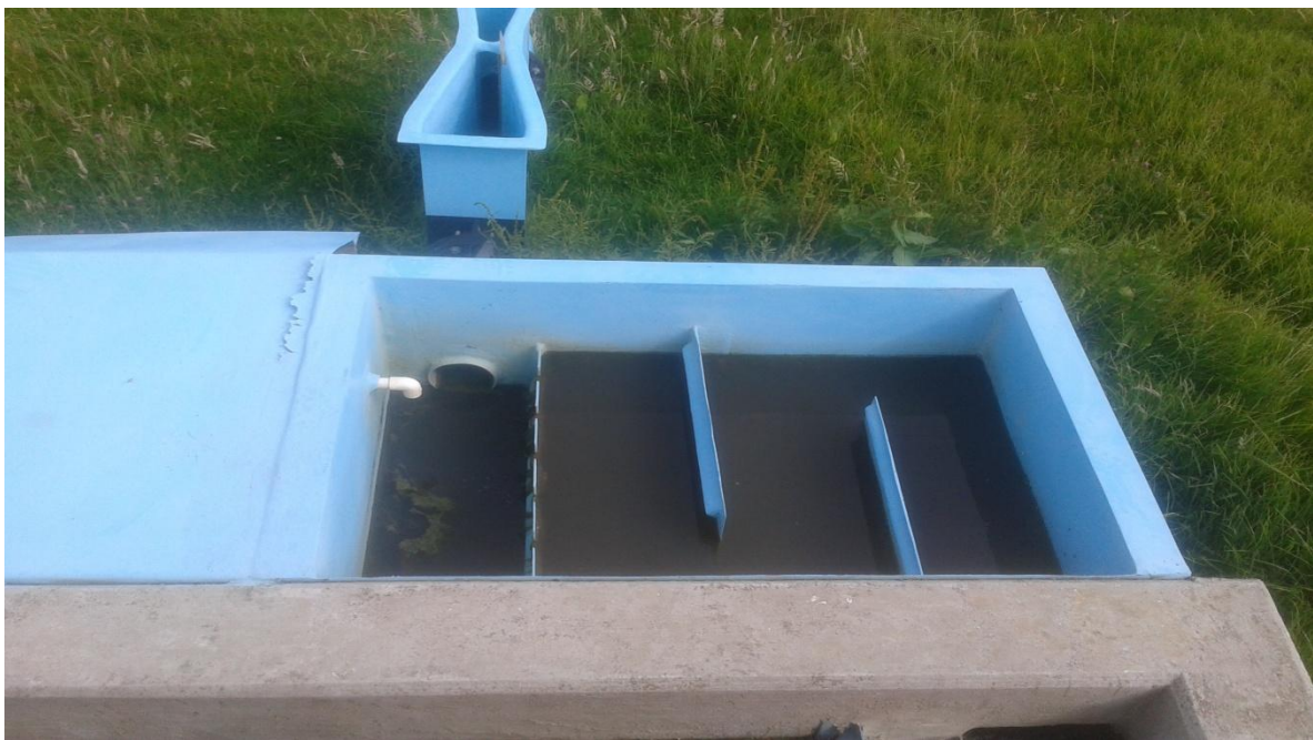
Figura 12. Salida de agua de la Planta de tratamiento de agua residual
