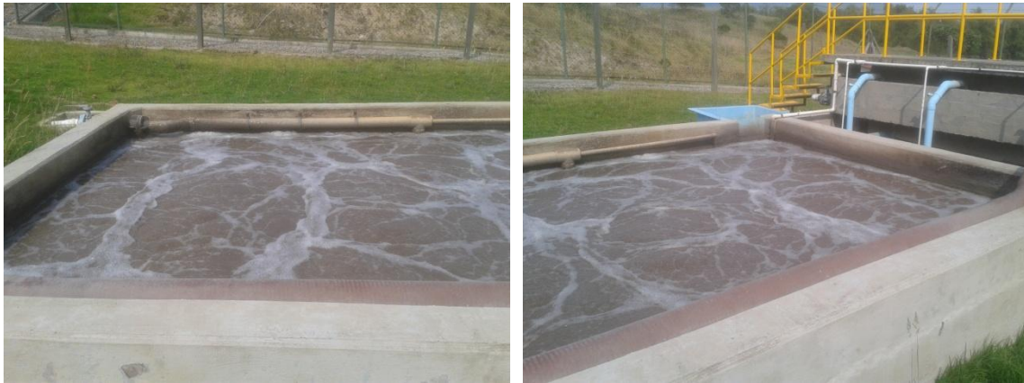
Figura 4. Proceso de aireación de la PTAR
